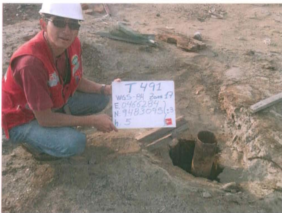
Fotografía N° 1. El pozo T_491 se observó inactivo, sin cabezal ni válvulas que aseguren su hermetismo.
