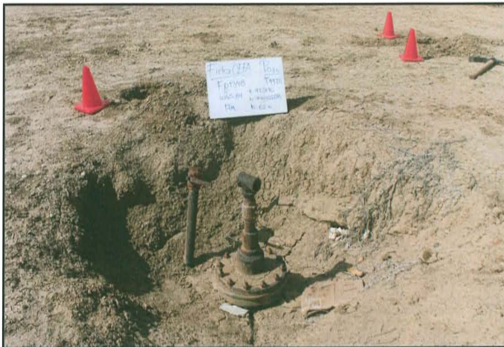
Fotografía N° 1. Pozo T 1970 presenta casing con brida de 16 pulg, válvula de 3 pulg y 0,73 m de altura desde la base del hoyo de 0,4 m de profundidad. Al lado se observa un tubo con válvula de 2,5 pulg y 0,54 m de altura.
