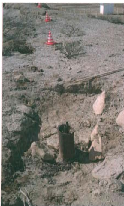
Fotografía N° 2. Se observa la situación del pozo inactivo, cuyo casing se encuentra cortado y no presenta cabezal ni válvulas de cierre.
