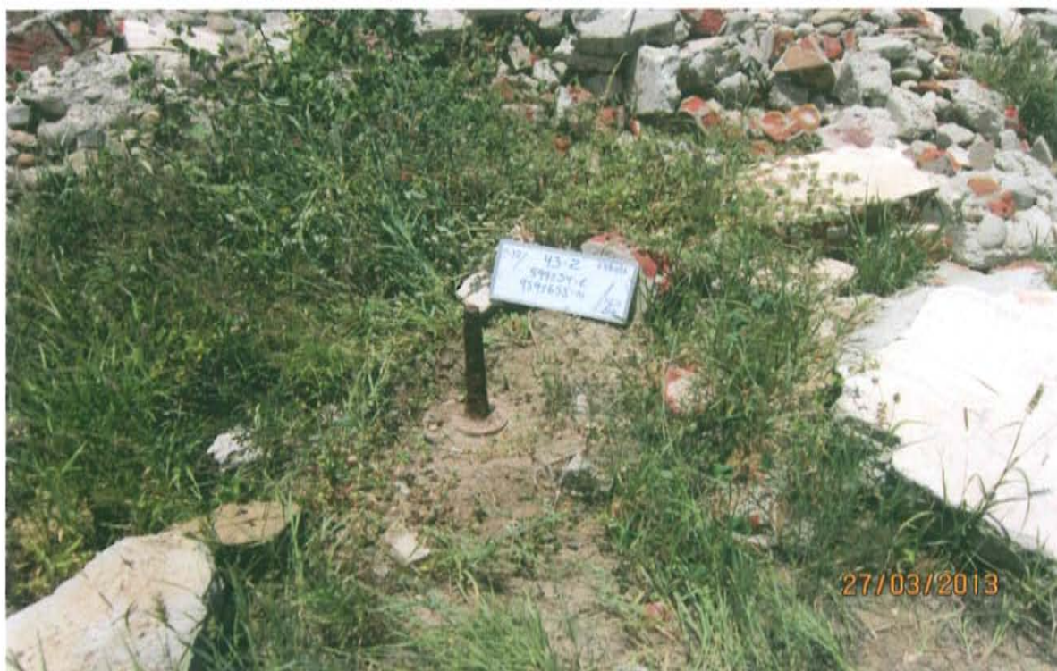
Fotografía N° 01. Pozo con código OSINERGMIN 43-Z, se observa el casing corroído, rodeado de vegetación y por restos de desmonte.
