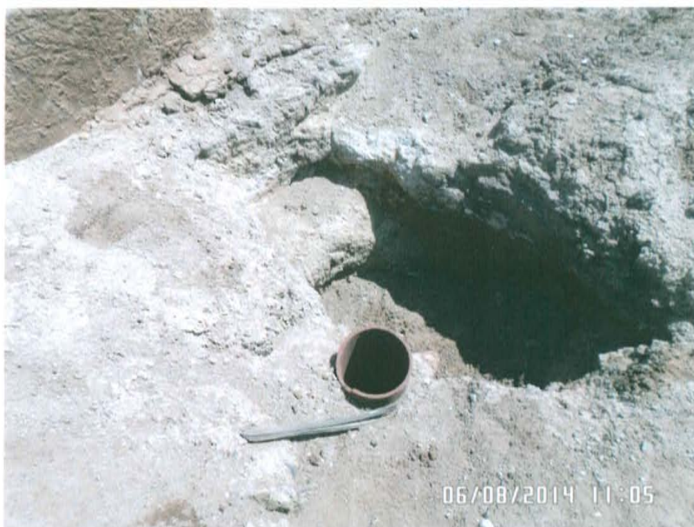
Fotografía N° 1. Vista pozo T4242 ubicado en una planicie sin vía de acceso, se observa el casing corroído y expuesto al ambiente.
