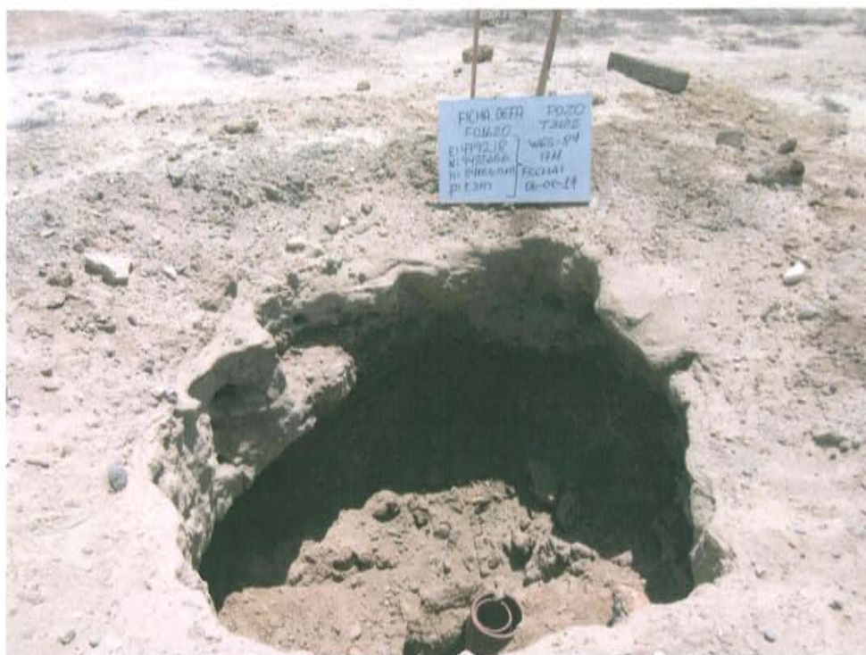
Fotografía N° 1. El Pozo T3102, presenta doble casing cortados y corroídos sin cabezal ni válvulas que aseguren su hermetismo.
