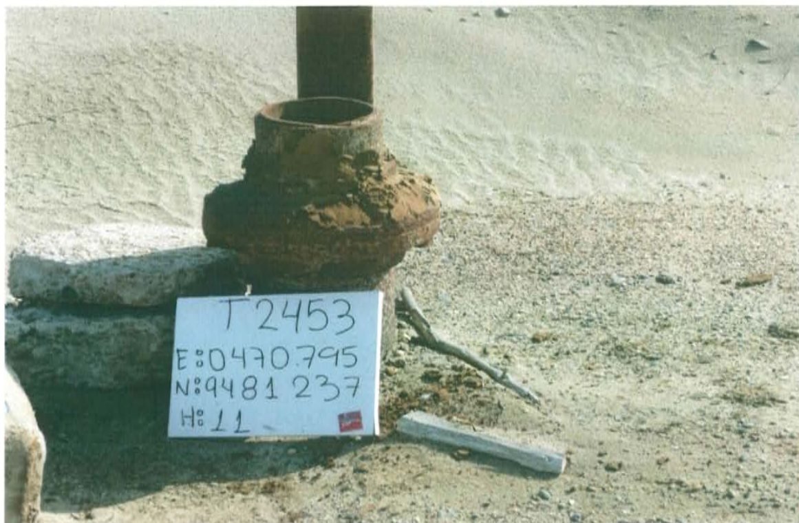
Fotografía N° 1. Pozo T2453 se observa un casing corroído, con cabezal abierto expuesto 0,6m en relación al suelo.
