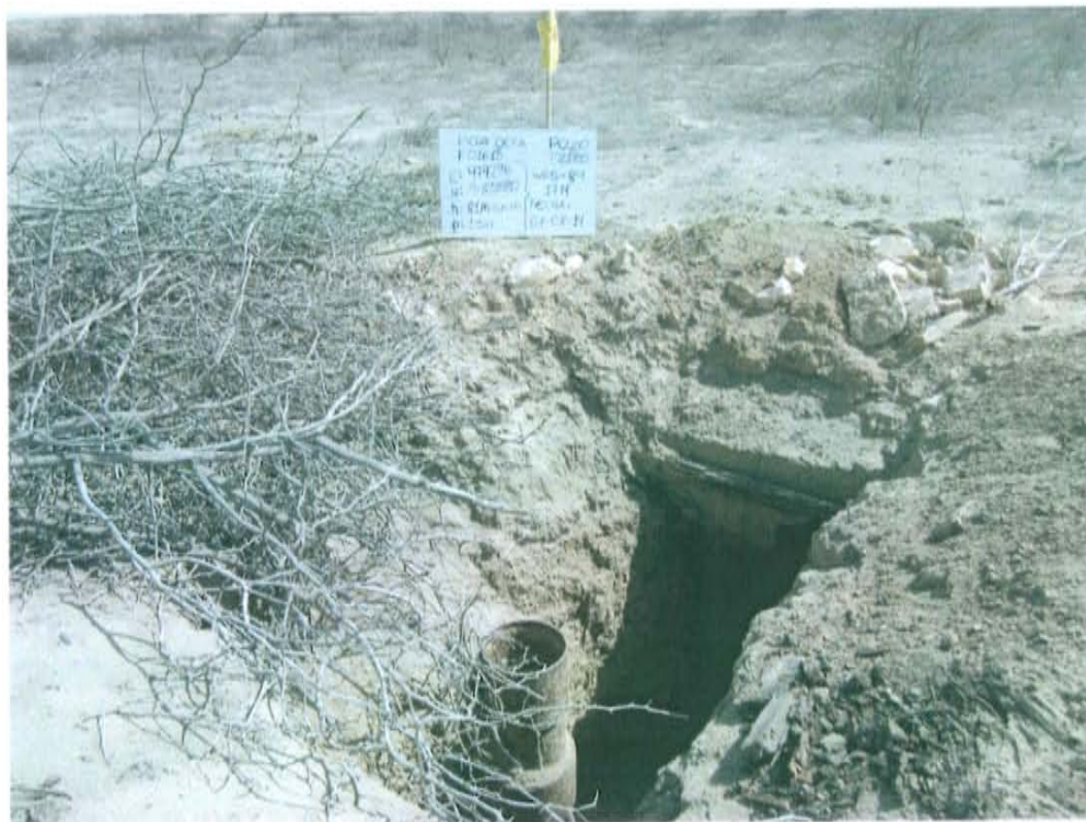
Fotografía N° 1. El Pozo T2180, presenta casing de aproximadamente 9,5 pulgadas corroído y lleno de arena.
