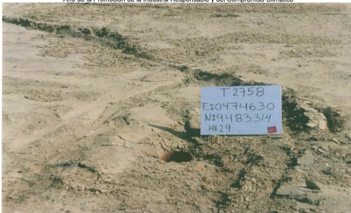
Fotografía N° 1. El Pozo T2758 se encuentra al ras del suelo presenta casing abierto con un diámetro de apertura de 6 pulgadas.
