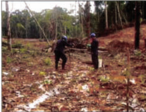
Foto 07: Realizando calicatas para la muestra M-02 en otro sector del área remediada.
