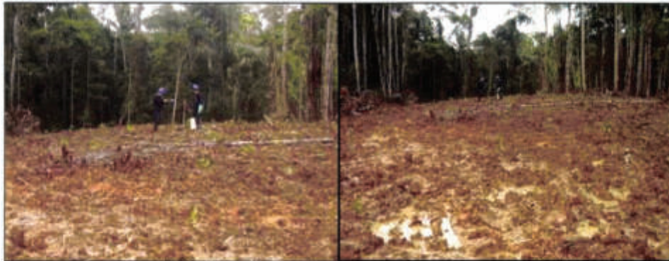
Foto 07: Personal de GyM realizando las calicatas en la zona central del sitio remediado para la colecta de la muestra M-02.
