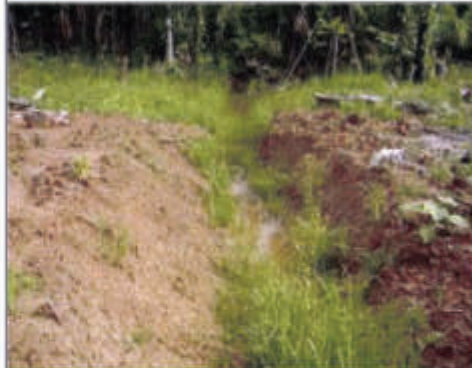
Foto 11: Canal central construido para drenaje de agua pluvial, para evitar empozamientos en el área remediada. La turbidez del agua propia de las aguas de la zona, no se evidencia visualmente presencia de hidrocarburos, este canal principal tiene salida a la Quebrada Piedra Negra.
