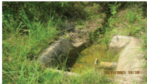
Tubería de descarga del tanque sumidero
