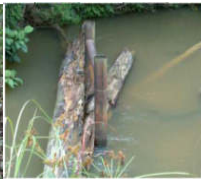
Vista de marco H en el cauce de la quebrada Pucacuro
