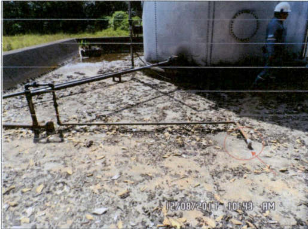
Fotografía N° 1.01: Muestra el Codo de 1" x 90° en la línea de descarga del tanque, ubicado al lado este del tanque, a 0.15 m sobre la losa del área estancia y dentro del sistema de contención. (Coordenadas UTM WGS84: 332984 E, 9703865 N).
