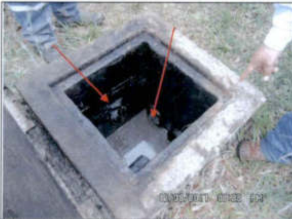
Fotografía: Muestra buzón de reunión del drenaje cerrado de la plataforma de raspatubos, desde donde se dirigen al tanque.
