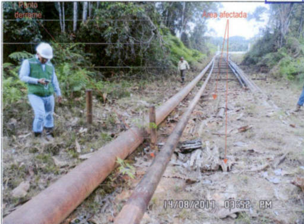
Fotografía N° 8.01: Muestra el Punto de fuga donde se originó el derrame. Se ubica en la línea de prueba de 6" ubicado aproximadamente a 100 m antes de cruzar la vía de acceso del lado sur de la Batería Dorissa. (Coordenadas UTM WGS84: 367002 E, 9696603 N).
