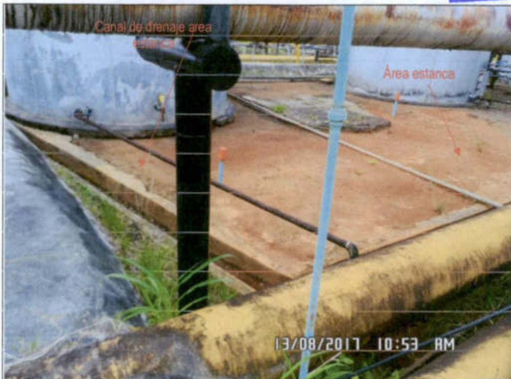
Fotografía N° 4.02: Muestra el Área estanca de los tanques de condensados. Ambos tanques comparten una misma área estanca con diques revestido de concreto, el piso muestra deterioro del concreto. (Coordenadas UTM WGS84: 341232 E, 9689962 N).
