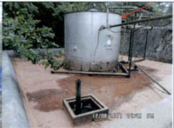
Fotografía: Muestra el tanque de 100 Bis sumidero, que acumula los drenajes cerrados de la plataforma de raspatubos
