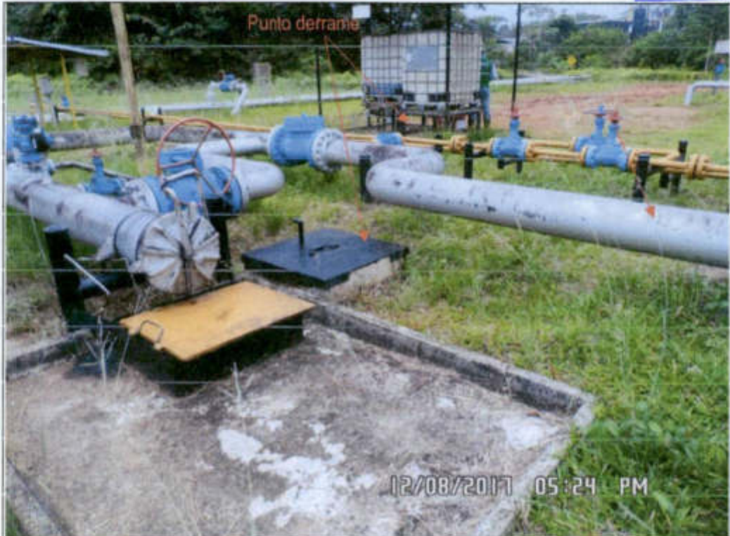
Fotografía N° 5.01: Muestra punto de falla, donde se originó el derrame. Rebose por el sistema de drenaje interno de la caseta de inyección de químicos para el sistema de raspabombos, desde el buzón de reunión. (Coordenadas UTM WGS84: 341093 E, 9689666 N).
