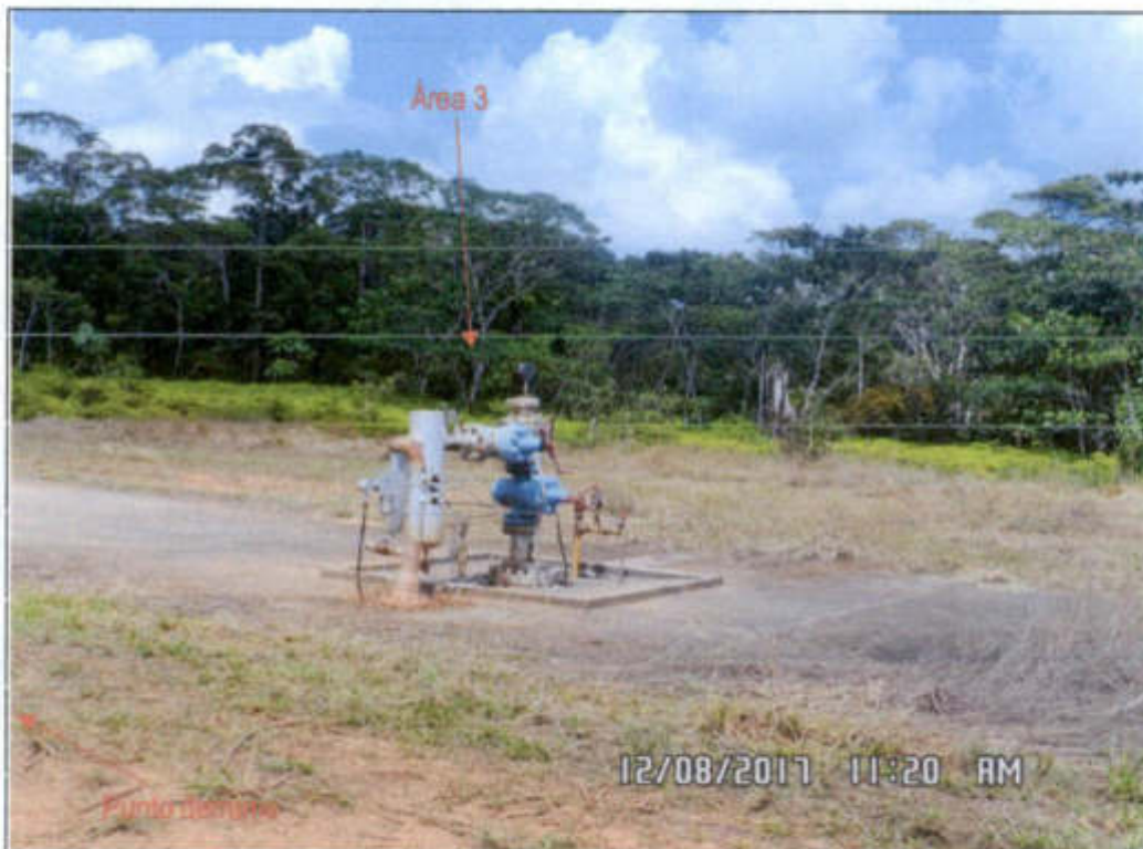
Fotografía N° 2.05: Muestra el Pozo CN-07 ubicado al norte del tanque de 500 Bbis de capacidad, es un pozo productor. Coordenadas UTM WGS84: 333004 E, 9703781 N).
