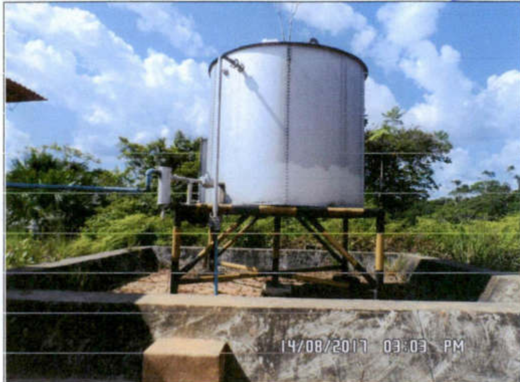
Fotografía N° 9.01: Muestra el Tanque de diesel consumo interno, Tanque metálico empacado de 100 Bbls de capacidad, en área estanca de concreto sobre un caballete metálico. (Coordenadas UTM WGS84: 367264 E, 9696656 N).
