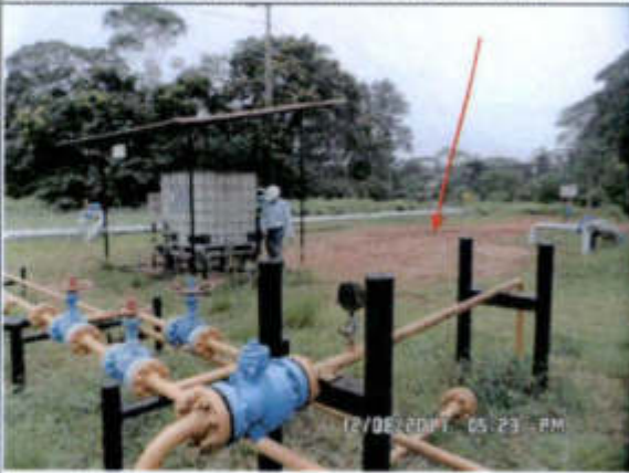
Fotografía: Muestra el área afectada por el derrame en la plataforma de raspatubo.
