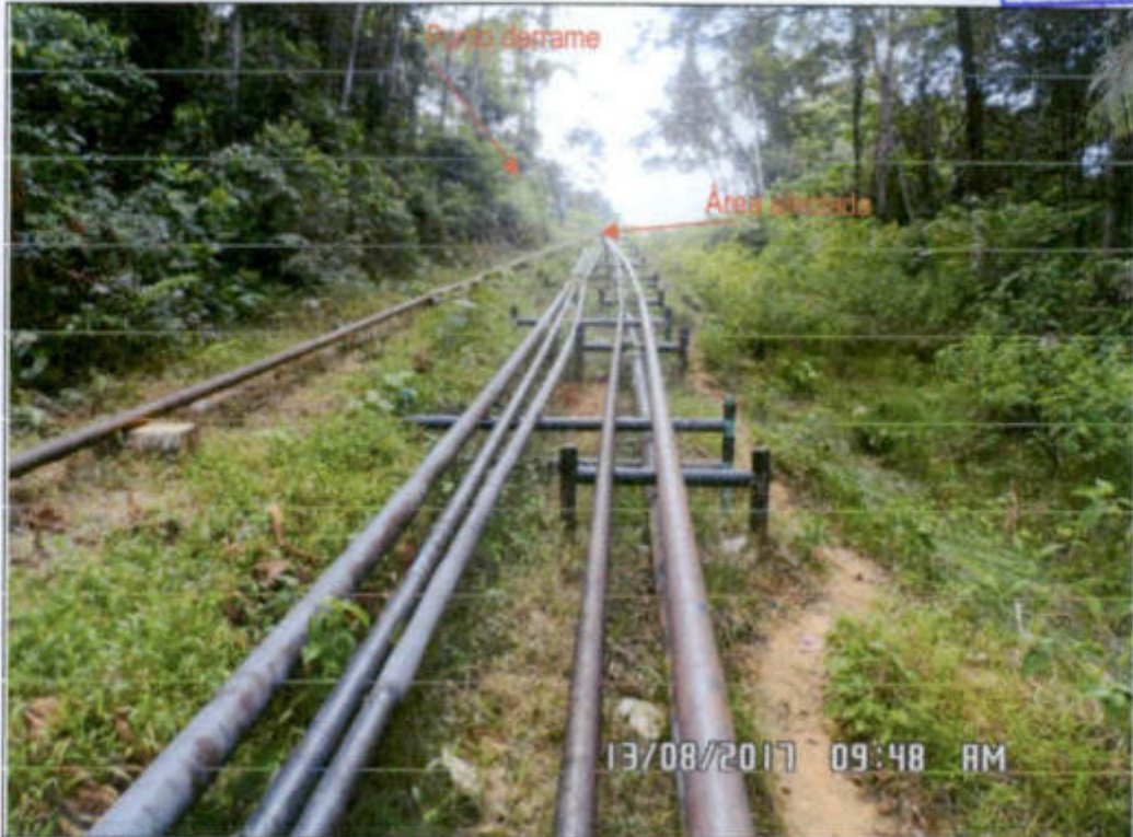
Fotografía N° 3.02-A: Muestra el área posiblemente afectada por el derrame, terreno en pendiente moderada, no se aprecia restos de hidrocarburos o materiales relacionados con el derrame, se verificó hasta 100 aguas abajo del punto del derrame. (Coordenadas UTM WGS84: 340773 E, 9689874 N).
