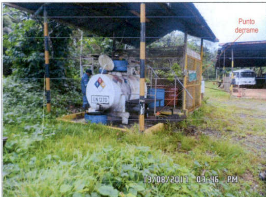
Fotografía N° 6.01: Muestra el Tanque de residuos de aceite usado, es un tanque metálico de 180 galones de capacidad, en el cual se almacenan los aceites usados generados en los talleres CORPESA. (Coordenadas UTM WGS84: 340607 E, 9689157 N).
