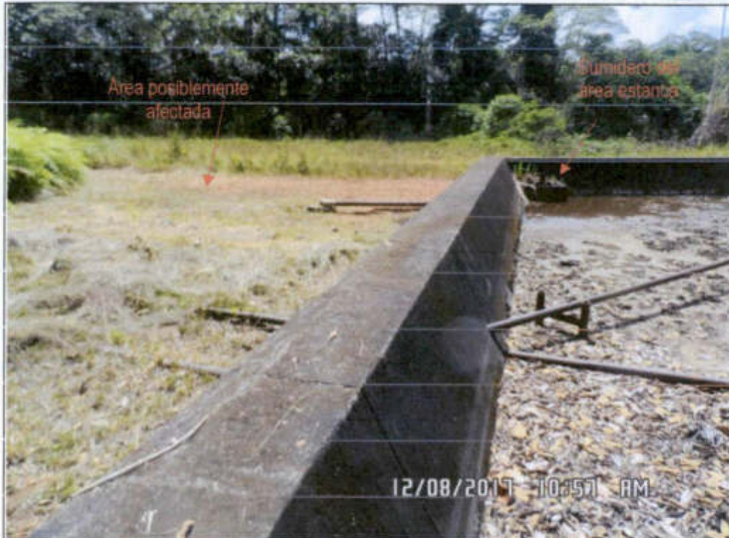
Fotografía N° 2.04: Muestra el Terreno adyacente y fuera del área estanca, visualmente no se aprecia restos de hidrocarburos o material relacionado en el suelo. (Coordenadas UTM WGS84: 332993 E, 9703881 N).
