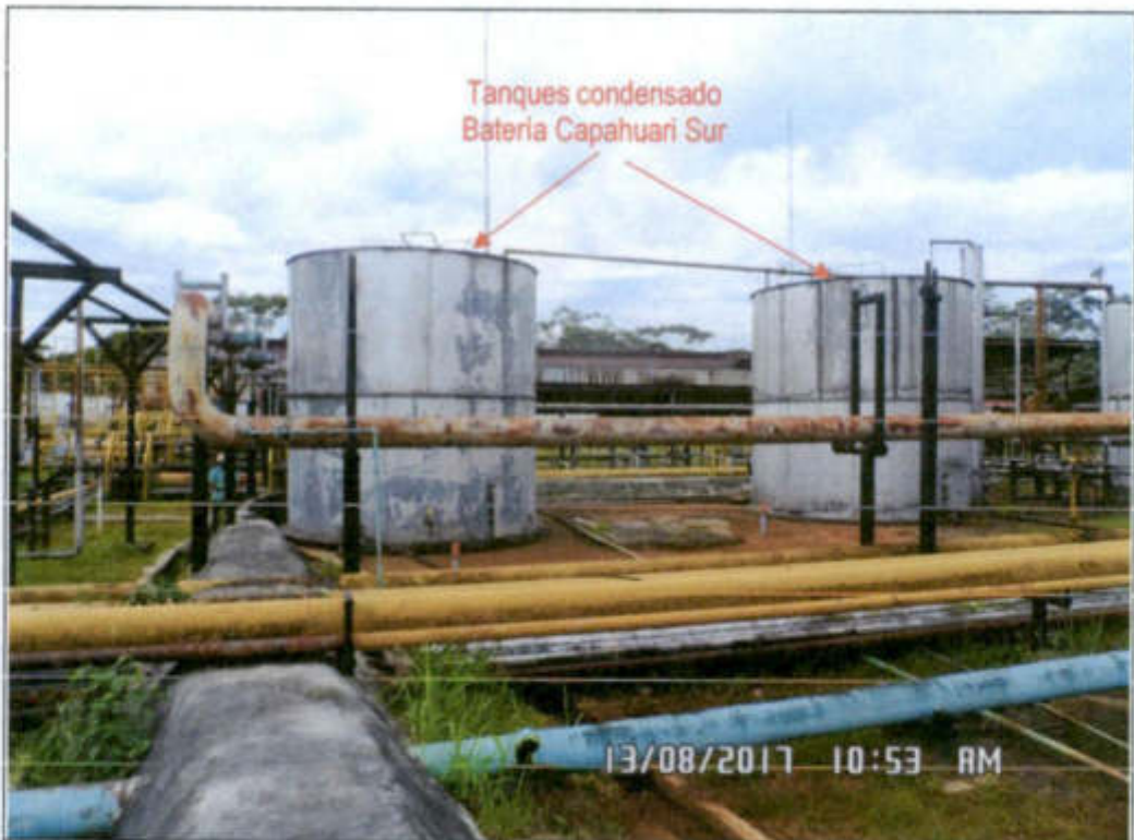
Fotografía N° 4.01: Muestra el Punto de falla que ocasionó el derrame, rebalse en los tanques emperrados de condensados de 500 Bbls. ubicados en el área estanca al este de la batería Capahuari Sur. (Coordenadas UTM WGS84: 341231 E, 9689970 N).
