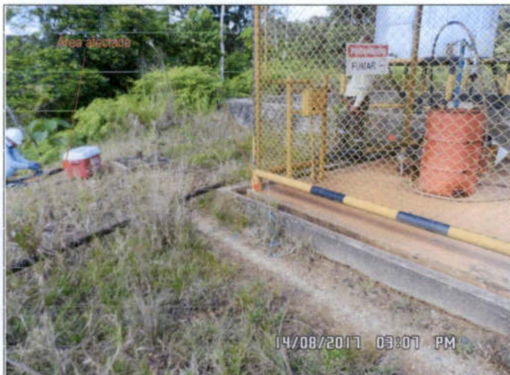
Fotografía N° 9.02: Muestra el Punto de falla donde se originó el derrame. Se ubica en el punto de despacho, que también cuenta con un sistema de contención que sin embargo rebosa y afecto los suelos adyacentes, falla operacional. (Coordenadas UTM WGS84: 367260 E, 9696657 N).
