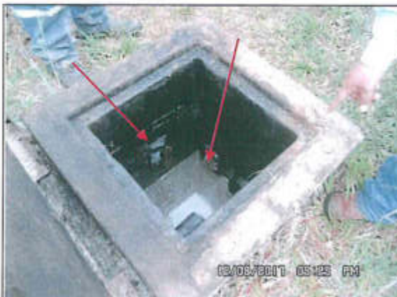
Fotografía: Muestra buzón de reunión del drenaje cerrado de la plataforma de raspatubos, desde donde se dirigen al tanque.
