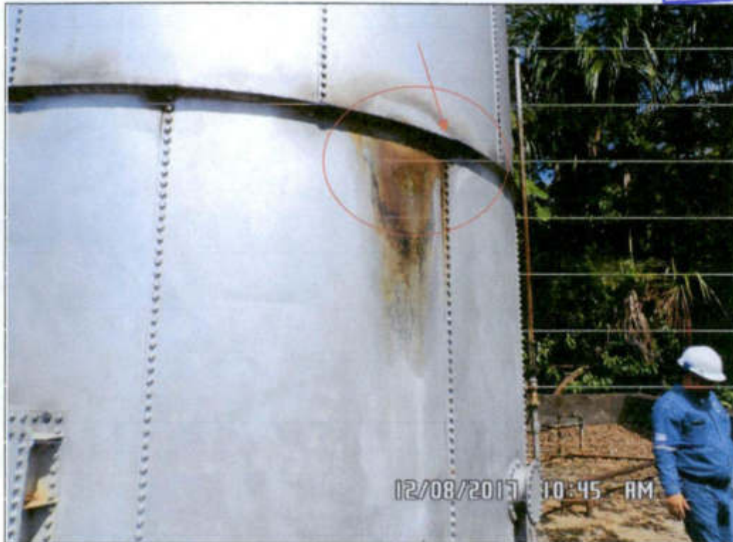
Fotografía N° 2.02: Muestra Unión con pernos de los anillos del tanque de 500 Bbts, la falta se presentó entre el primer y segundo anillo en la cara noreste del tanque. Coordenadas UTM WGS84: 332984 E, 9703865 N).
