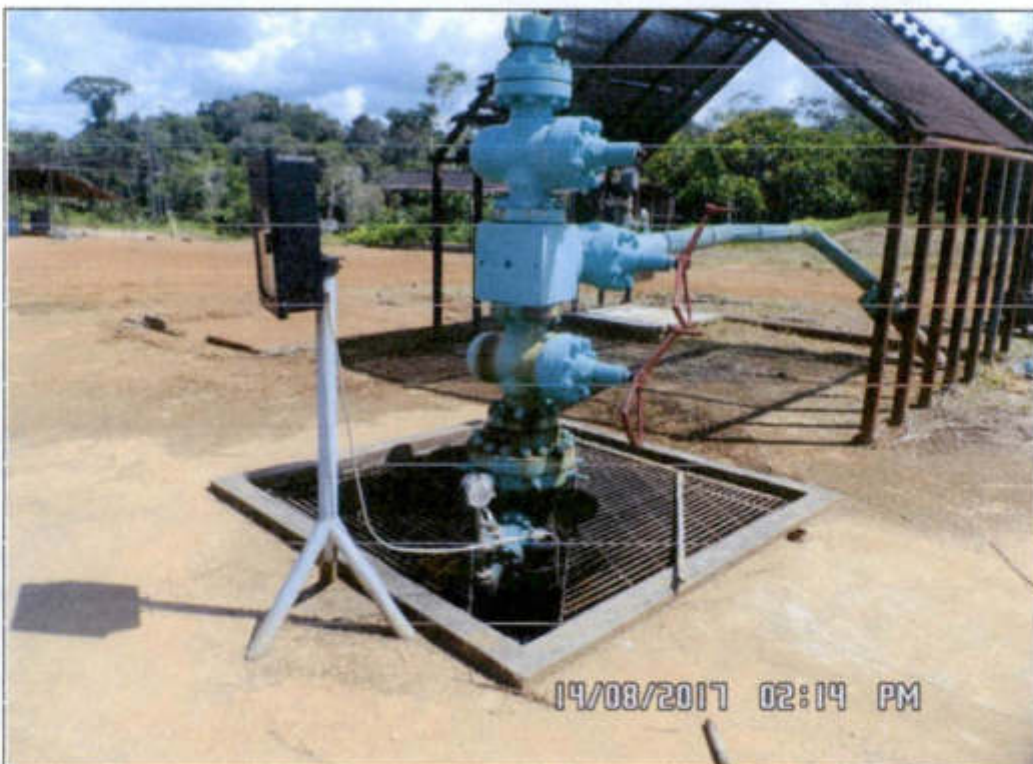
Fotografía N° 7.03: Muestra el Pozo inyector-Dorissa 08, se ubica junto a los pozos 5D, 6D, 7D y 8D, presión anular cero, presión inyección 1250, barton y sistema de inyección de químicos. (Coordenadas UTM WGS84: 366082 E, 9697290 N).
