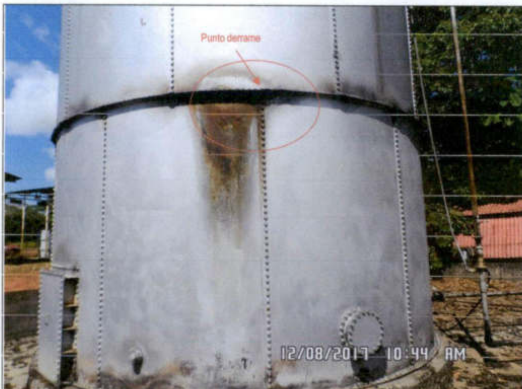
Fotografía N° 2.01: Muestra el un tanque vertical emperrado, que almacena diesel para abastecer a la mini central eléctrica Capahuari Norte, el derrame se habría producido por la manipulación de los pernos entre los anillos del tanque, actualmente está reparado y operativo. (Coordenadas UTM WGS84: 332084 E, 9703885 N).
