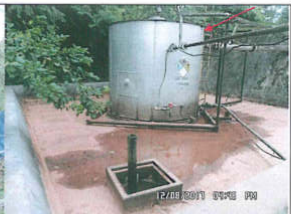
Fotografía: Muestra el tanque de 100 Bls sumidero, que acumula los drenajes cerrados de la plataforma de raspatubos.
