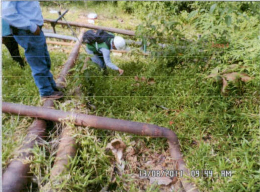
Fotografía N° 3.01: Muestra el punto de falla que ocasionó el derrame, Codo con ampliación de 3" a 4" actualmente reparado y en funcionamiento, el derrame se habría producido por corrosión del accesorio. (Coordenadas UTM WGS84: 340888 E, 9689891 N).
