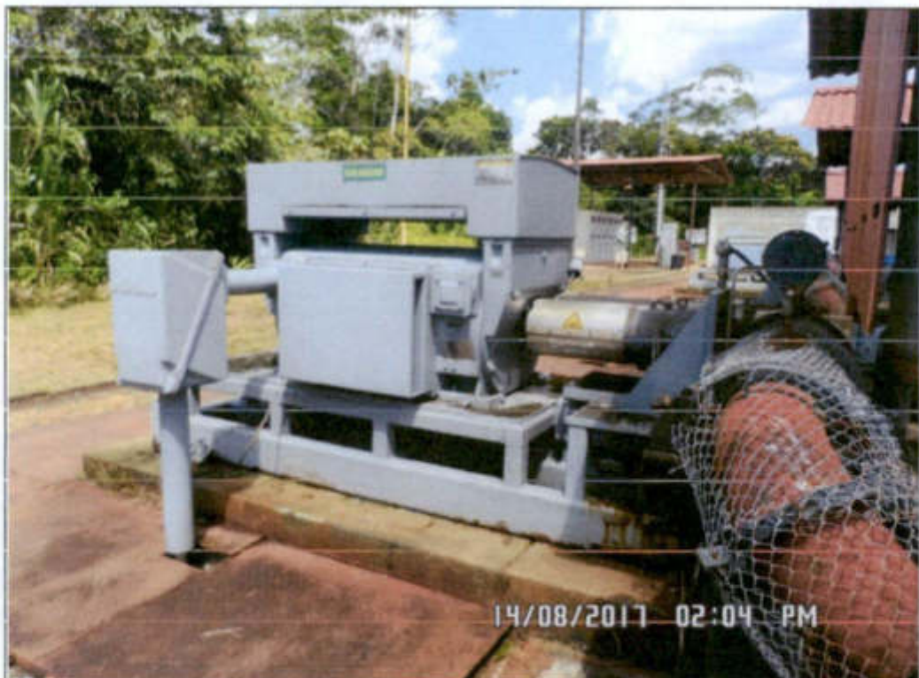
Fotografía N° 7.01: Muestra el Área de electrobombas 2 y 5, Área ubicada al este del pozo inyector Dorissa 08, dos electrobombas de uso alternado, succión de 110 PSI, inyección 1250 PSI. (Coordenadas UTM WGS84: 366143 E; 9697310 N).
