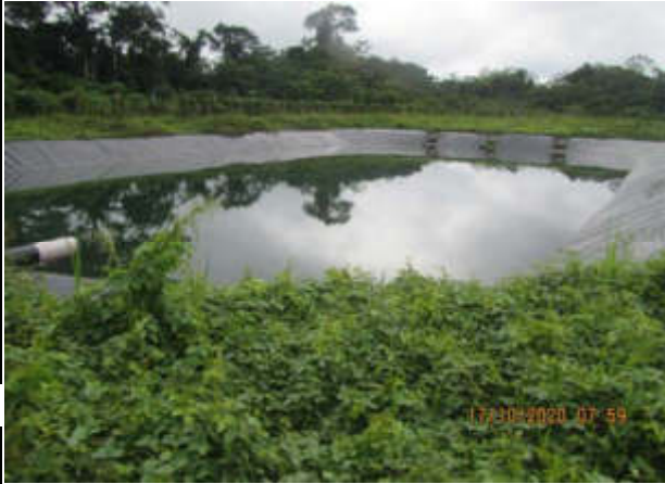
Planta de Tratamiento de Aguas Residuales (PTAR) dentro del área cercada del sitio S0143
