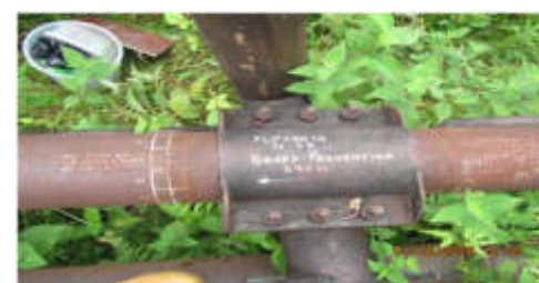
Grapa preventida encontrada es tubería sector noroeste del sitio S0375.
