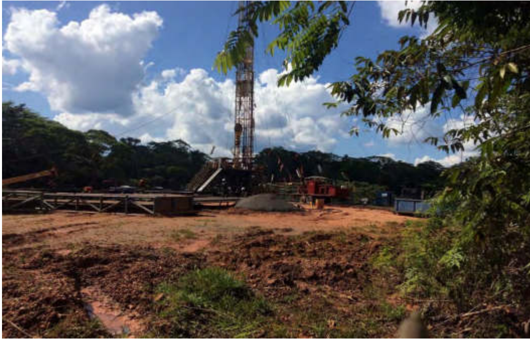
Fotografía 7. Se observa el pozo CAPN-3 en mantenimiento (no operativo).
