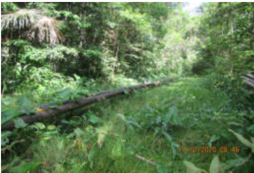
Vista del oleoducto que transporta hidrocarburos desde el campo de producción Capahuari Norte hasta la Estación de Andoas que se superpone con el Sitio S0444.
