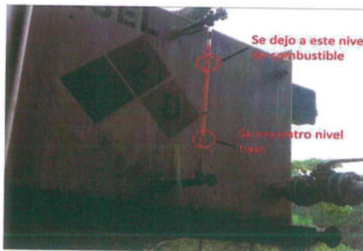
Diferencia de nivel del tanque N°01 de diésel hurtado Mini central Capahuari Sur.
