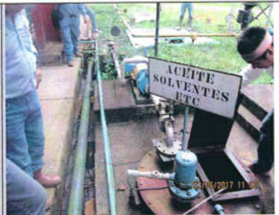
Foto N° 2. Vista de la boca del Sump Tank (tanque subterráneo) ubicado en la Minicentral Eléctrica de Capahuari Sur del Lote 192, donde se generó el derrame de diésel por rebose. Coordenadas UTM (WGS84): 341026 E / 9690046 N.
