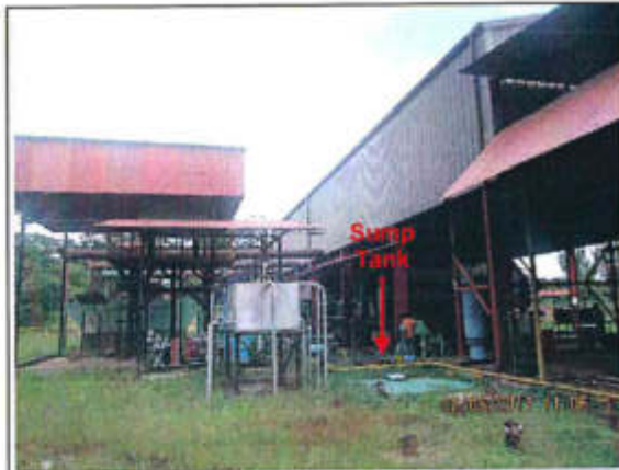
Foto N° 1. Vista de la Minicentral Eléctrica de Capahuari Sur del Lote 192. Coordenadas UTM (WGS84): 341039 E / 9690043 N.
