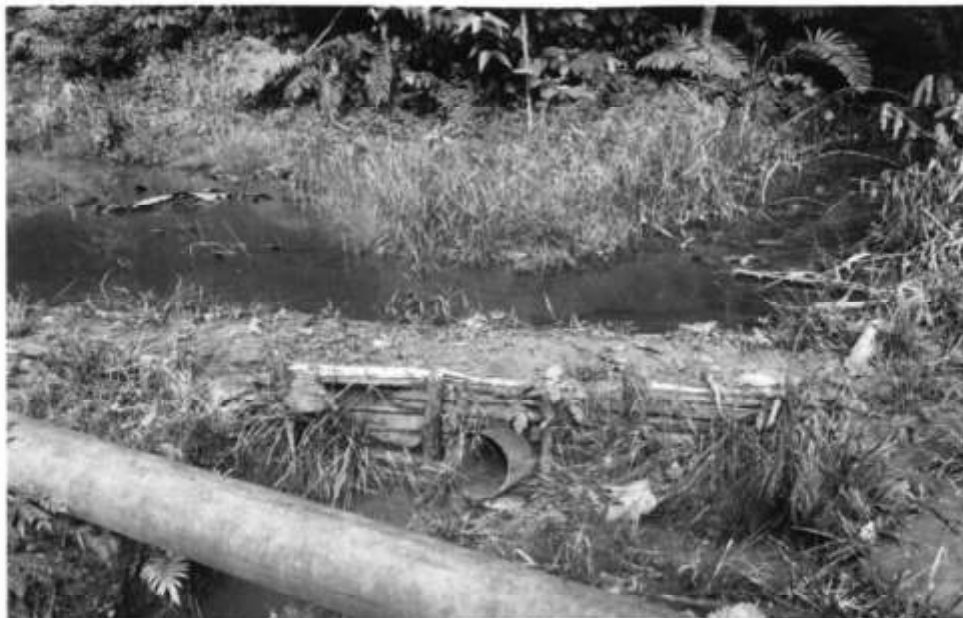
Fotografía 5. Segundo dique sobre el cauce de la misma quebrada, aguas arriba del primero en la Fotografía 4.
