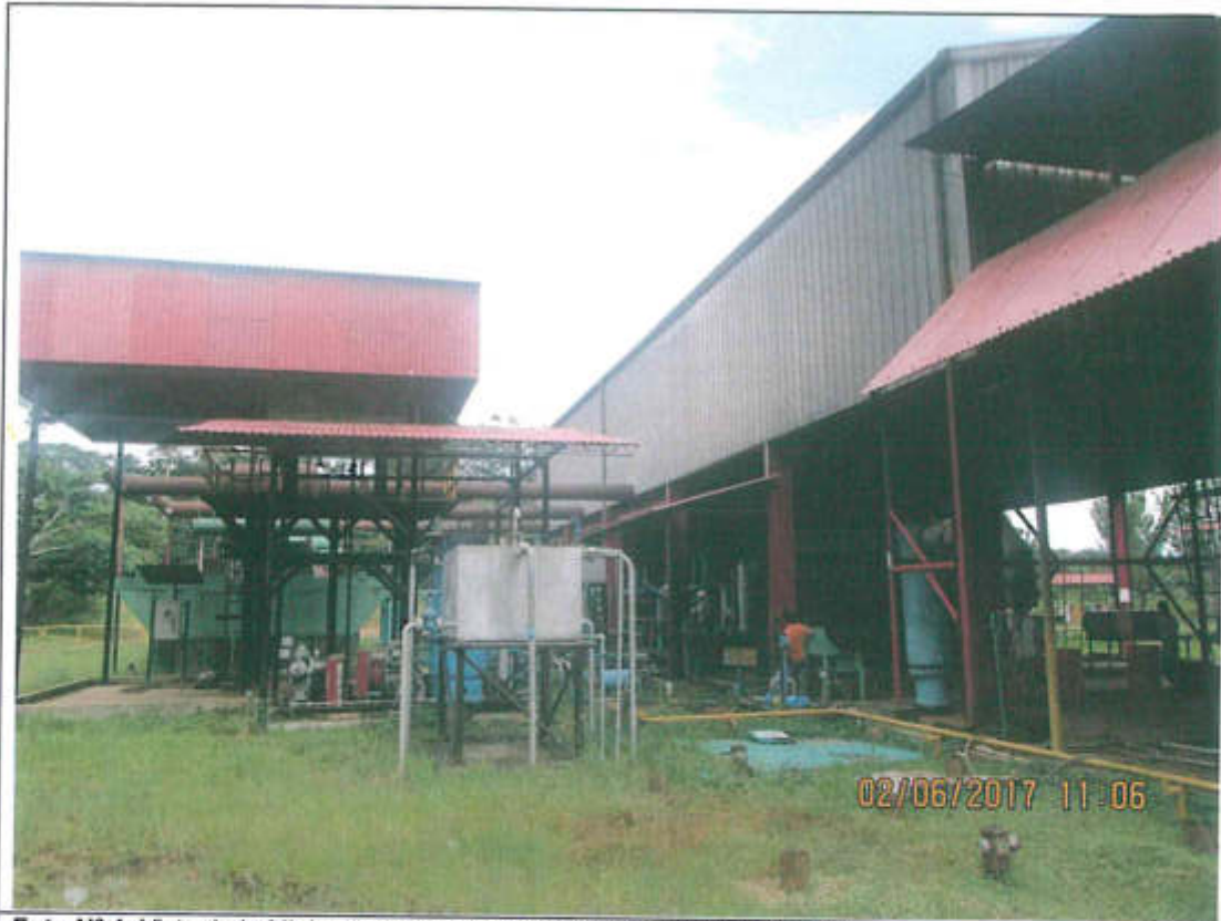
Foto N° 1. Vista de la Minicentral Eléctrica de Capahuari Sur del Lote 192. Coordenadas UTM (WGS84): 341039 E / 9690043 N.
