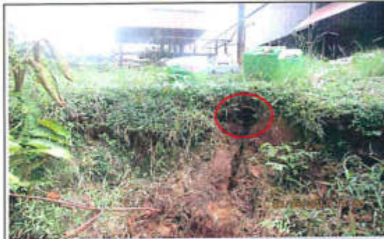
Foto N° 3. Vista de la salida del sistema de drenaje pluvial proveniente de la canaleta de la Minicentral Eléctrica hacia la quebrada s/n. Ubicación donde discurrió el diésel. Coordenadas UTM (WGS84): 341043 E / 9690035 N.
