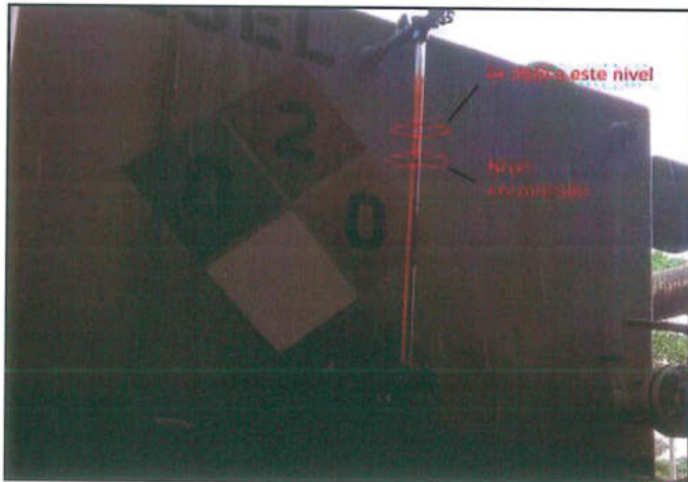
Fotografía N°02 - Tanque Diario de Diesel de MEP-02 – CAP. SUR.
