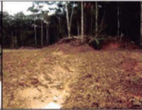
Foto 14: Canal de drenaje principal, el cual circula por el borde y centro del sitio remediado.
