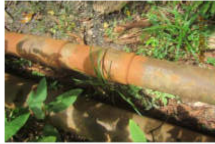
Vista de los ductos provenientes de la Bateria San Jacinto y que se dirige a la Bateria Shiviayacu. En uno de los ductos se observa un nipe (colocado para reparación del ducto) en las coordenadas (404106E / 9742754N (UTM WGS84, 18 M)
