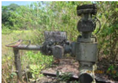
Vista del pozo SANJ-23HST ubicado en la plataforma K.
