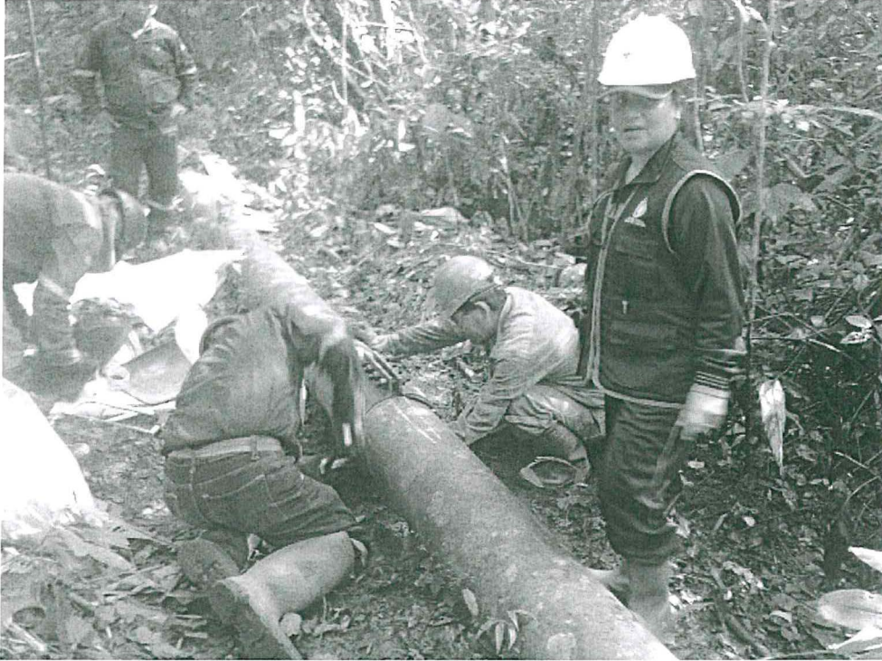
Fotografía N° 4: Personal de CORPESA retirando la grapa del punto del derrame
