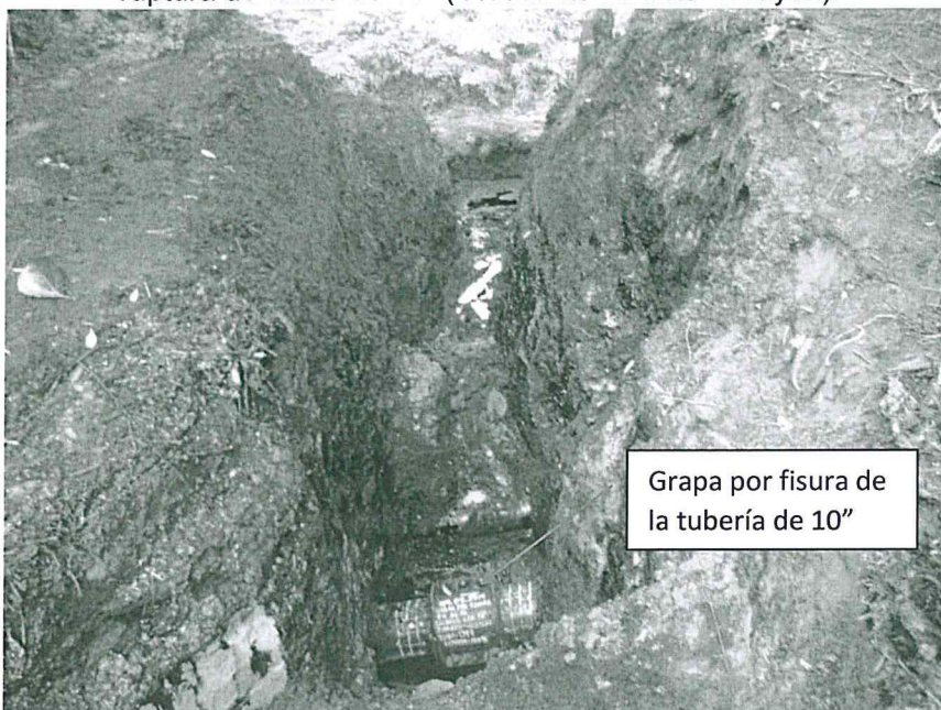
Fotografía N° 2. Lugar donde ocurrió el derrame de hidrocarburos proveniente de la ruptura de ducto de 10" (Oleoducto Jibarito- Huayuri).
