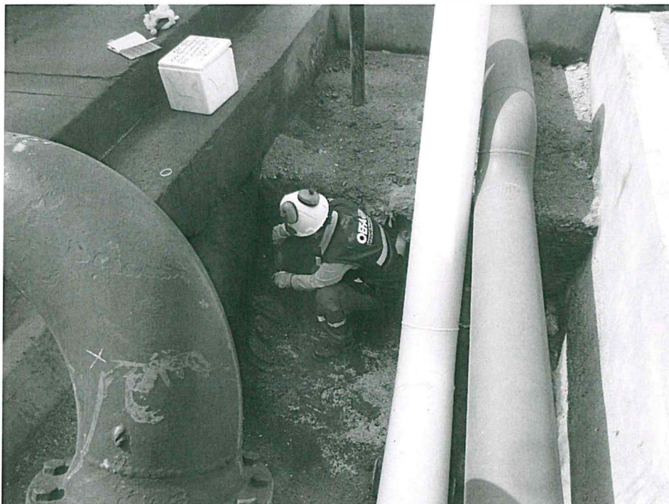
Fotografía 6. Punto de muestreo de suelo SU -02 TI. Terminal Ilo, empresa Consorcio Terminales. 18 de junio de 2014.
