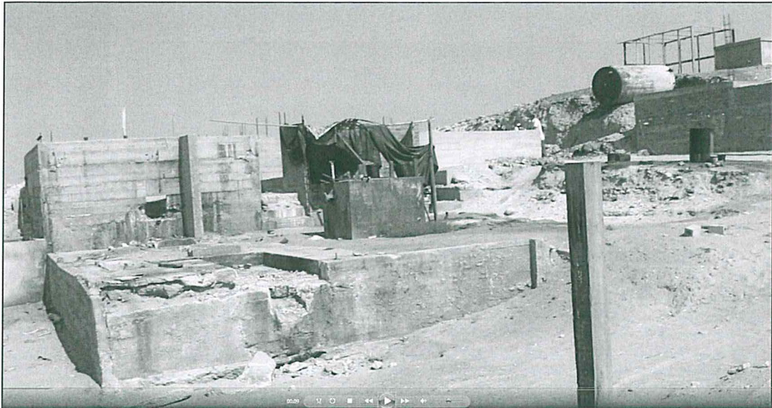
Foto N° 03. Parte de las instalaciones de la planta informal de procesamiento hidrobiológicos, en desuso. Fundo Virgen de Chapi, 23 de abril 2014.
