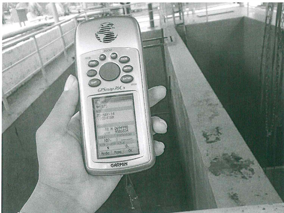
Fotografía N° 9. Poza API de la Central Termoeléctrica de Iquitos
