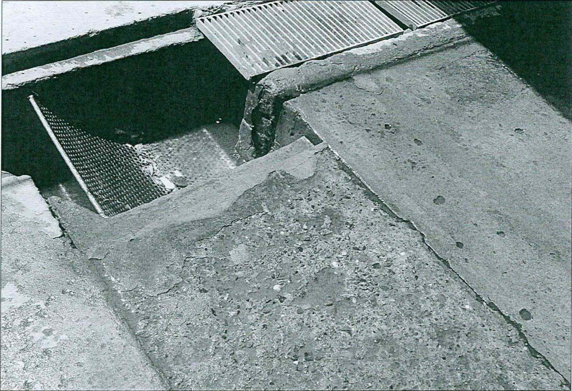
Fotografía N° 6. Canaleta cubierta con rejillas de 10 mm y caja de paso con mallas para retención de sólidos.
