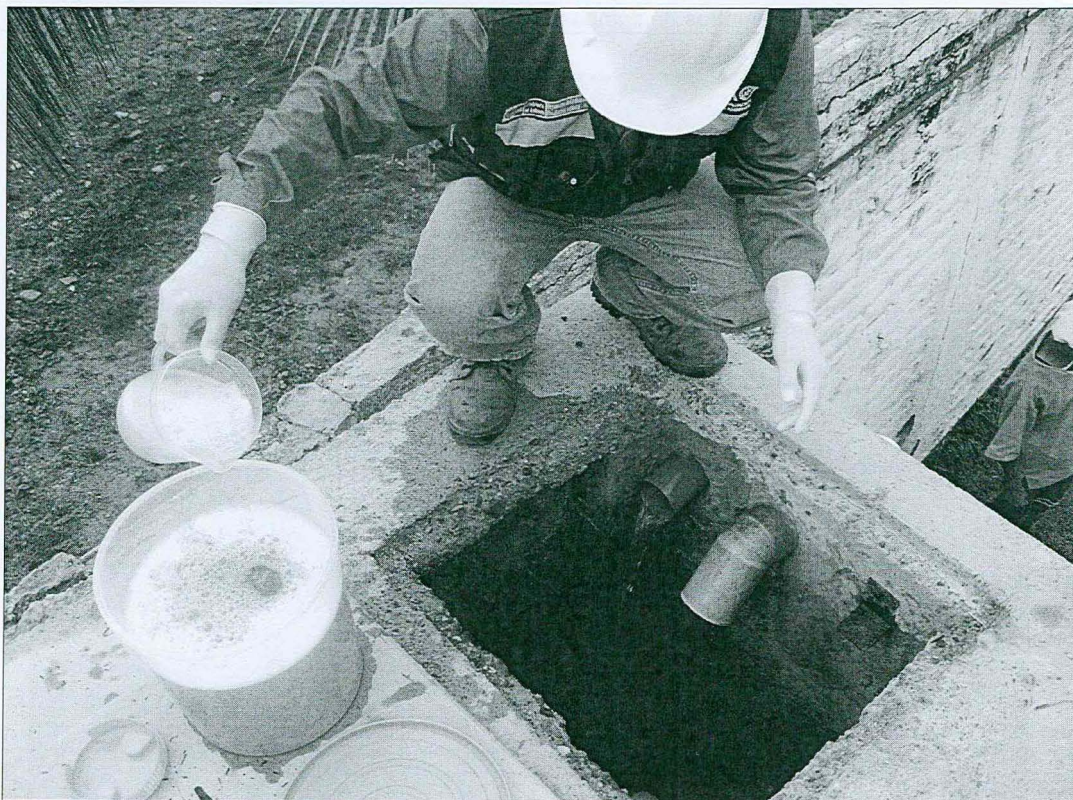
Fotografía N°13. Recolección del efluente a la entrada del tanque de almacenamiento, para la toma de muestras.
