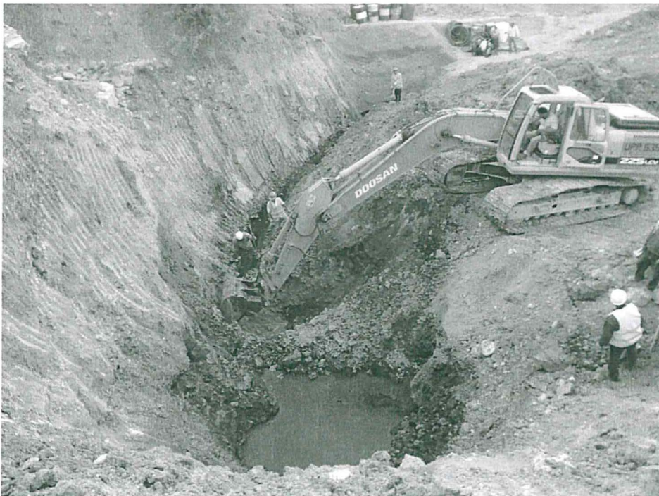
Fotografía N° 4. Área afectada por el derrame de hidrocarburos en el área de influencia del KM 547+463 del Oleoducto Norperuano
