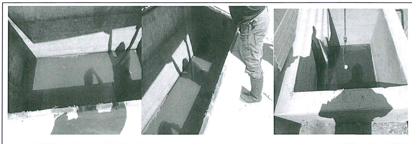
Fotografía N° 02. Planta de tratamiento de aguas residuales
