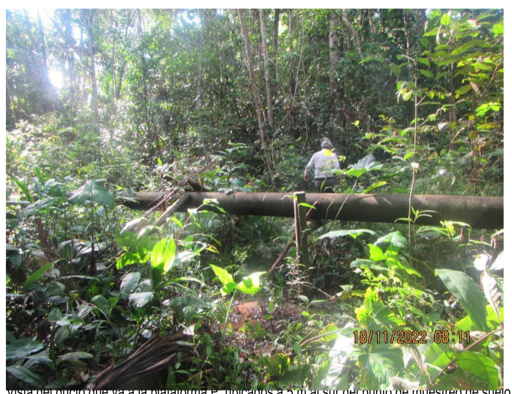
Vista del ducto que va a la plataforma P, ubicado a 5 m al sur del punto de muestreo de suelo S0350-SU-009
