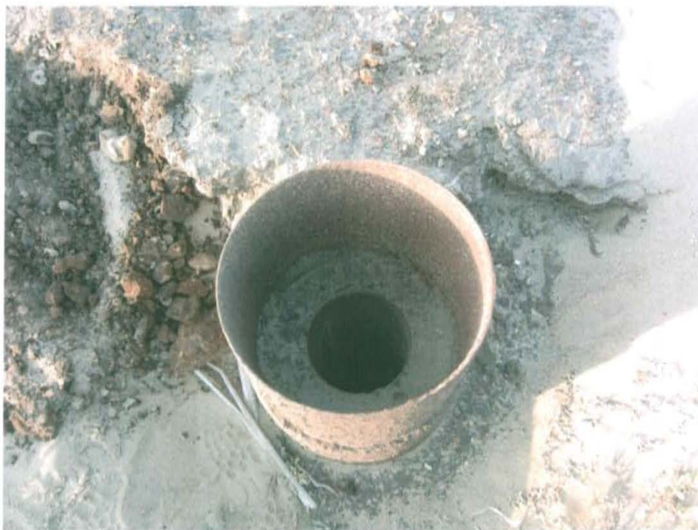
Fotografía N° 2. El Pozo T1177 presenta doble casing concéntricos en estado de corrosión, ambos casing se encuentran cementados en la sección anular.
