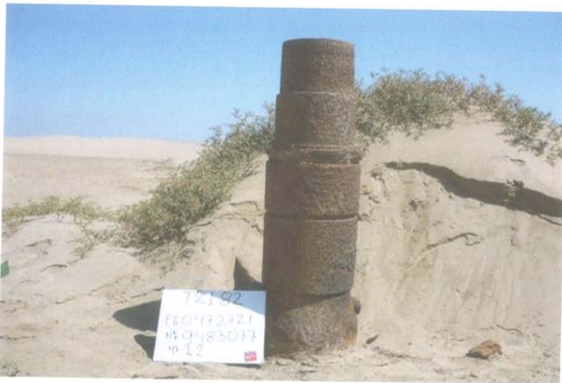
Fotografía N° 1. Identificación del pozo inactivo con código PERUPETRO T2182; presentará casing y tubo corroído de 1,31 m sobre el nivel del terreno.
