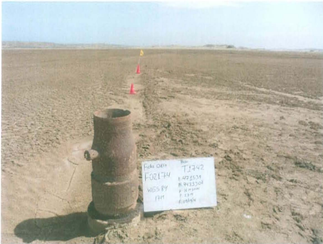
Fotografía N° 1. Se observa casing corroído que se encuentra abierto al ambiente y presenta afloramiento superficial de líquidos en su base.
