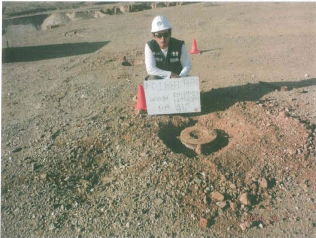
Fotografía N° 1. Pozo inactivo con código PERUPETRO T4771, se observa brida unida a cabezal del pozo enterrado con presencia de tierra en su interior.
