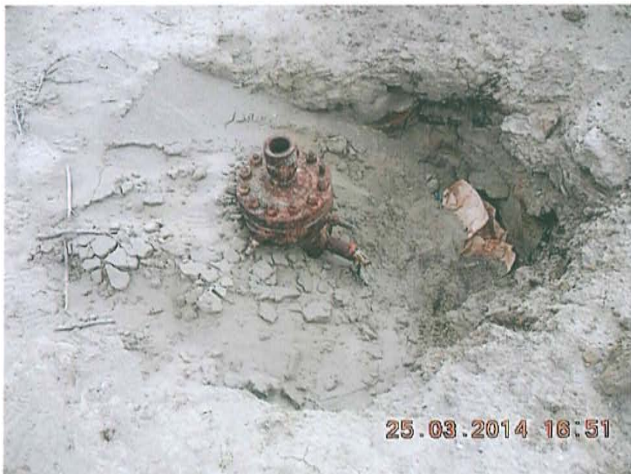
Fotografía N° 2. Se observa cabezal oxidado pero sin válvulas que aseguren el hermetismo del pozo T5028.
