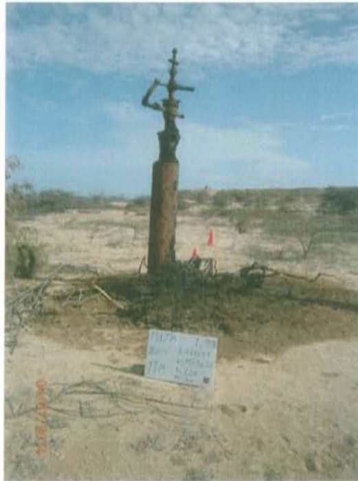
Fotografía N° 1. Vista de la ubicación del pozo inactivo expuesto al ambiente en estado de corrosión
