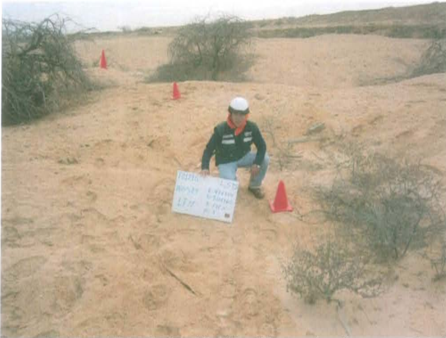
Fotografía N° 1. Vista de la ubicación del pozo inactivo expuesto al ambiente y en estado de corrosión.
