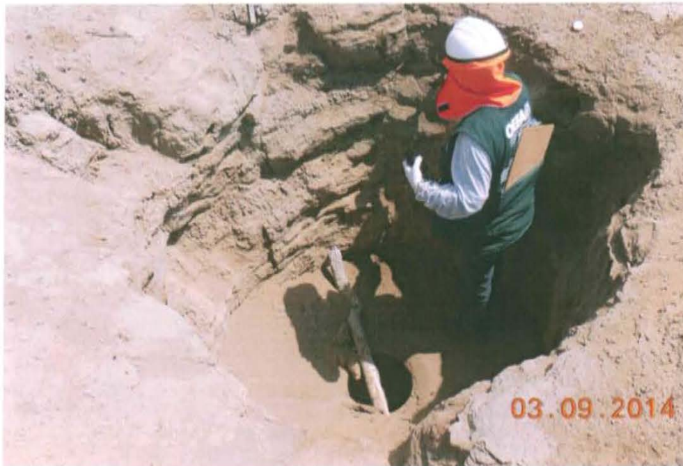
Fotografía N° 2. Se aprecia casing abierto sin elementos de cierre en superficie que garanticen un cierre hermético del pozo.
