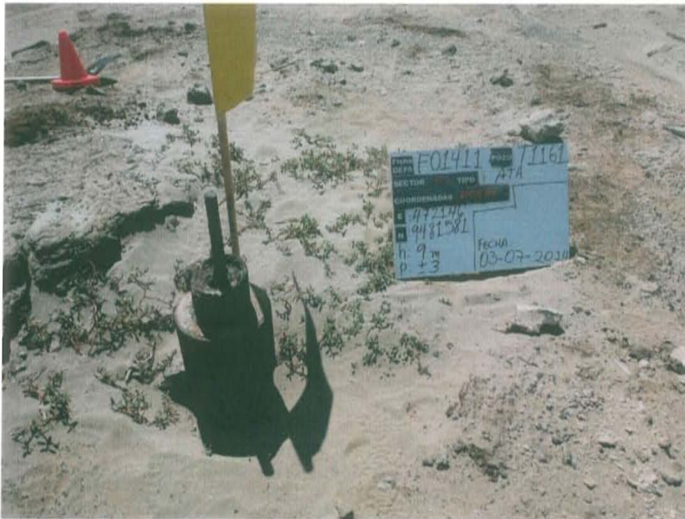
Fotografía N° 1. Se observa el Pozo T1161 con doble casing en estado corroído, sin cabezal ni válvulas que aseguren su hermetismo por lo que se considera abierto y expuesto al ambiente.
