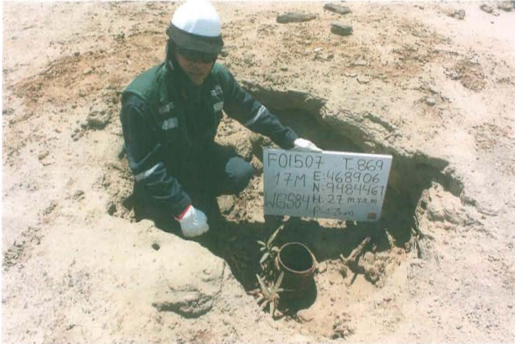
Fotografía N° 1. Pozo T_869, presenta casing de aproximadamente 7½ pulgadas de diámetro cortado y corroído.
