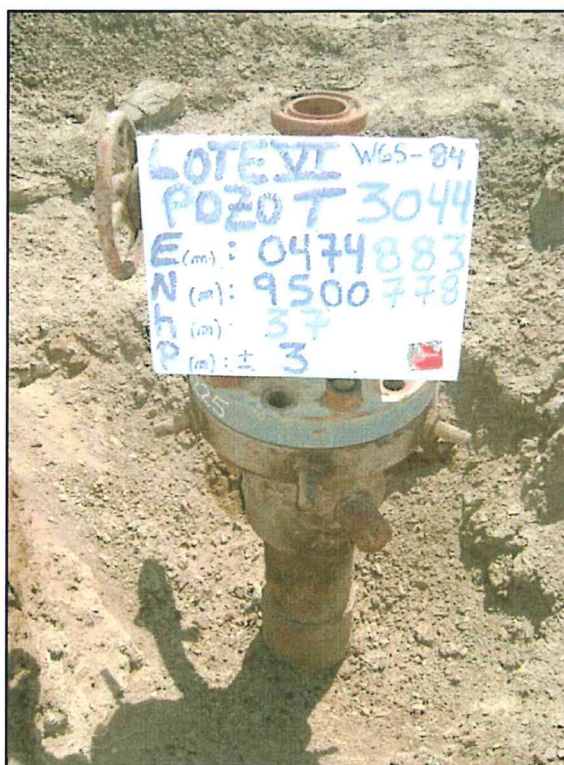
Fotografía N° 1. Se observa el Pozo T3044 que presenta un casing abierto y expuesto sobre nivel de superficie de un hoyo natural.
