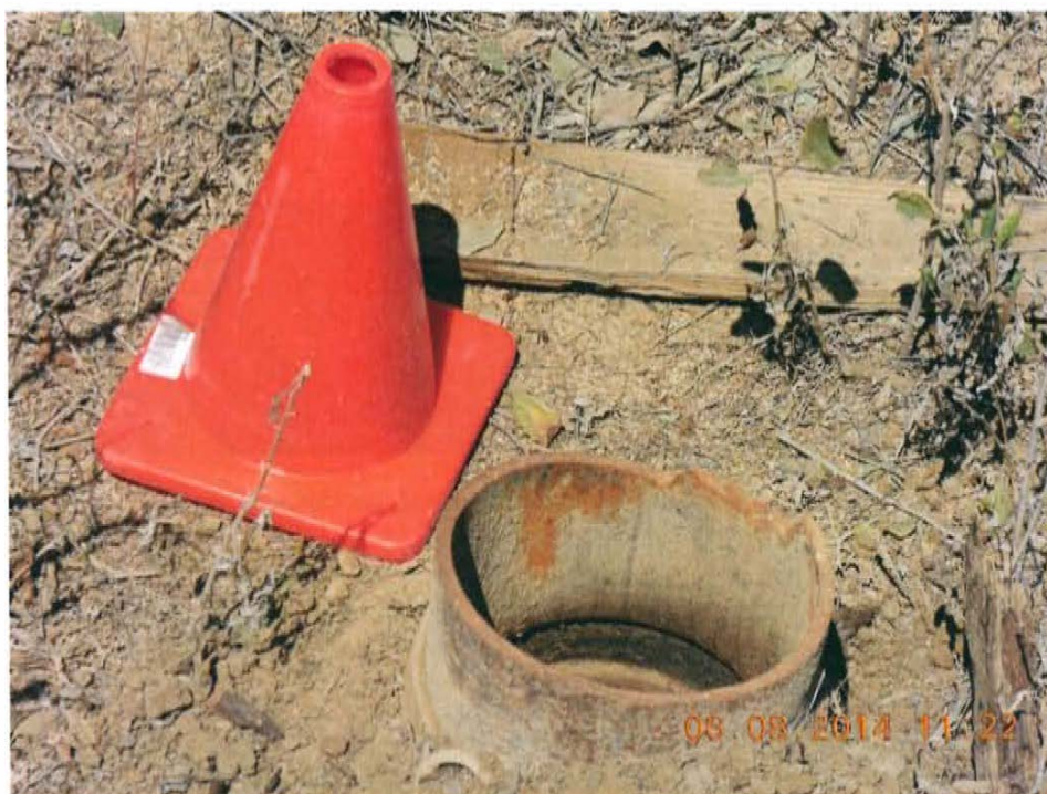
Fotografía N° 3. Se observa casing de 8 ½ plg corroído, cortado y abierto al ambiente sin accesorios que aseguren su hermetismo que sobresale 0,26 m del interior de un hoyo.
