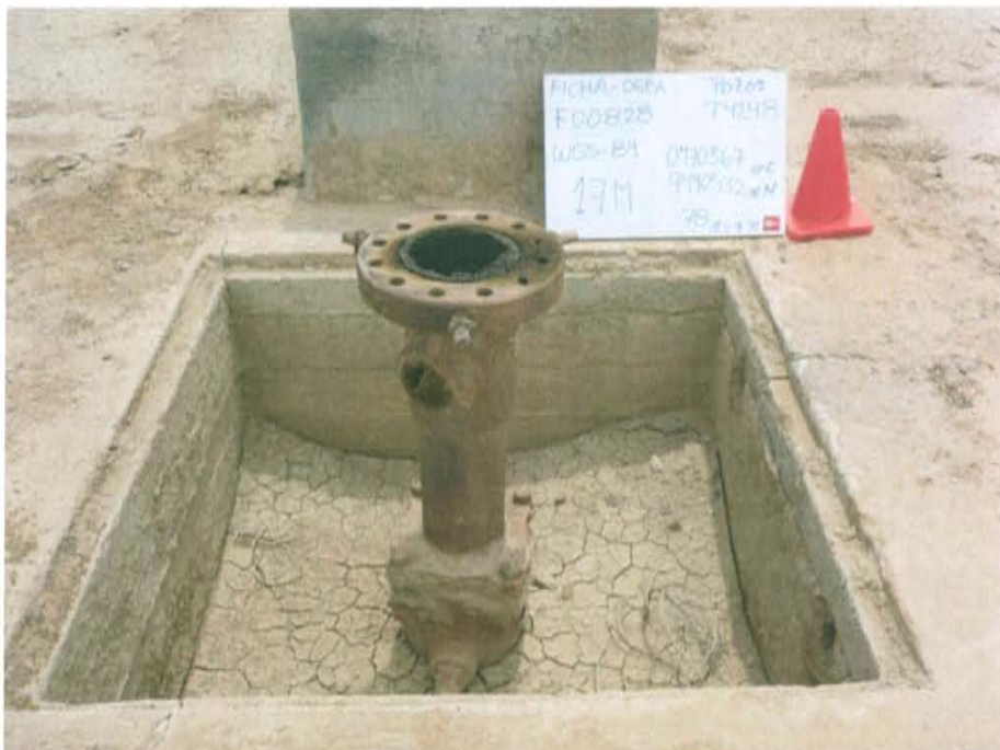
Fotografía N° 2. La estructura del pozo estaba abierta, sin elementos de cierre en superficie que garanticen un cierre hermético del pozo.
