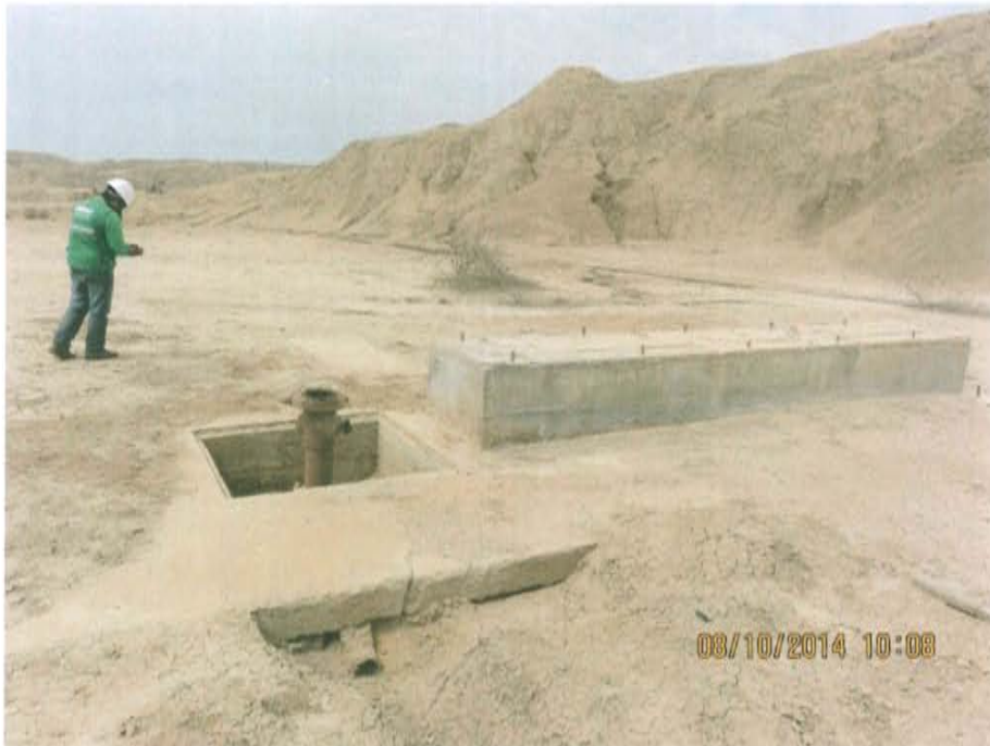
Fotografía N° 1. Se observa el pozo inactivo expuesto al ambiente en el interior de una cantina.
