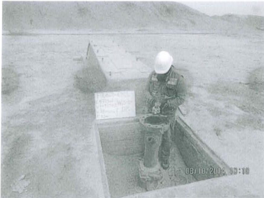
Fotografía N° 1. Medición en el punto F00828-EM01, ubicado en la boca del pozo.
