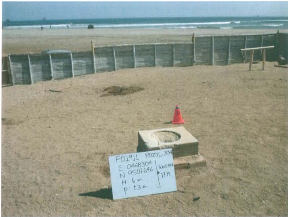
Fotografía N° 1. Identificación del pozo inactivo con código PERUPETRO L_334. Presenta casing abierto al medio ambiente.
