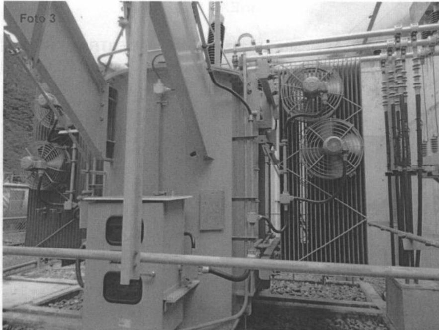
Fotografía N° 3. Evidencia del proceso de evaluación en campo del inventario de transformadores eléctricos de potencia en el patio de llaves de la Central Hidroeléctrica Machupicchu de la empresa EGEMSA, en el punto georeferenciado N° 1, del Cuadro N° 1. Coordenadas UTM WGS 84 (18L 764329E 8542206N)
