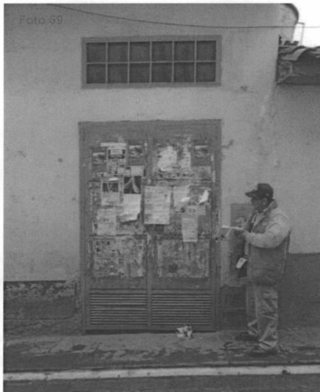
Fotografía N° 69. Evidencia de la evaluación del uso adecuado de aceites dieléctricos en transformadores de distribución en servicio, ubicados en la vía Pública del distrito del Cusco; en el punto georeferenciado N° 8, del Cuadro N° 5. La identificación de la Subestación es bastante dificultosa porque está llena de paleógrafos publicitarios. Coordenadas UTM WGS 84 (19L 177878E 8504047N)
