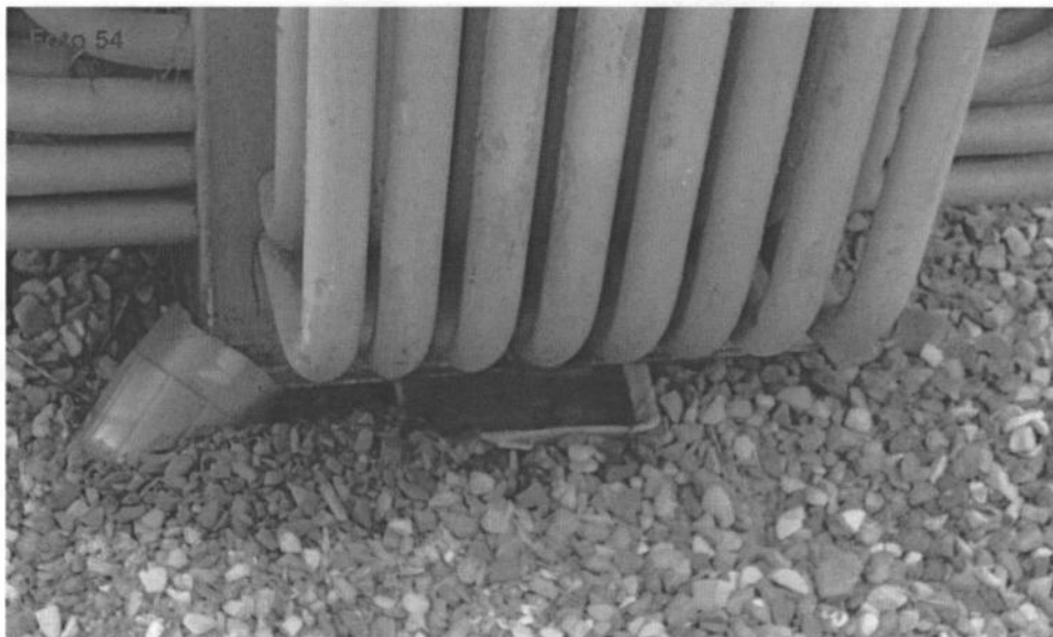
Fotografía N° 54. Evidencia del derrame de aceites dieléctricos y ubicación inadecuada del transformador de Serie N° A7078-2, dicho equipo está pendiente de definir su operatividad o destino final, se ubica en el punto georeferenciado N° 2, del Cuadro N° 3. Coordenadas UTM WGS 84 (18L 817106E 8508556N)
