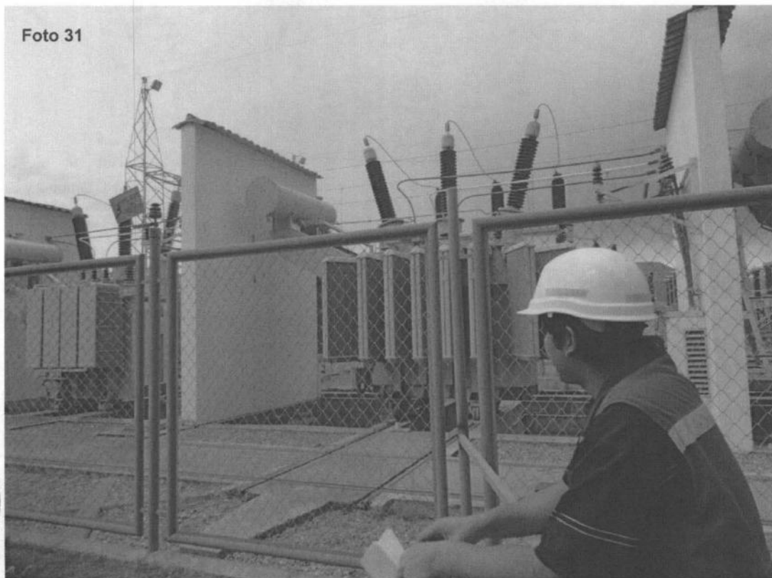
Fotografía N° 31. Vista panorámica de la distribución de los transformadores de transmisión de potencia, en el patio de llaves de la Subestación de Dolorespata de la empresa EGEMSA, en el punto georeferenciado N° 5, del Cuadro N° 2. Coordenadas UTM WGS 84 (19L 178327E 8502282N)
