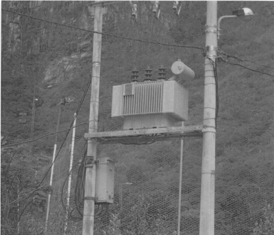
Fotografía N° 11. Evidencia de la identificación de un transformador aéreo de 25KVA aproximadamente que no se encuentra inventariado, se ubica frente al taller de mantenimiento general del campamento de la Central Hidroeléctrica Machupicchu de la empresa EGEMSA, en el punto georeferenciado N° 2, del Cuadro N° 1. Coordenadas UTM WGS 84 (18L 764763E 8542287N)
