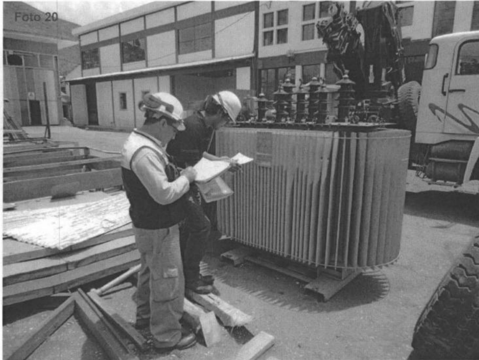
Fotografía N° 20. Evidencia del proceso de evaluación en campo del inventario de transformadores eléctricos en el patio del taller de mantenimiento general de la Central Térmica de Dolorespata de la empresa EGEMSA, en el punto georeferenciado N° 2, del Cuadro N° 2. Coordenadas UTM WGS 84 (19L 178368E 8502002N)
