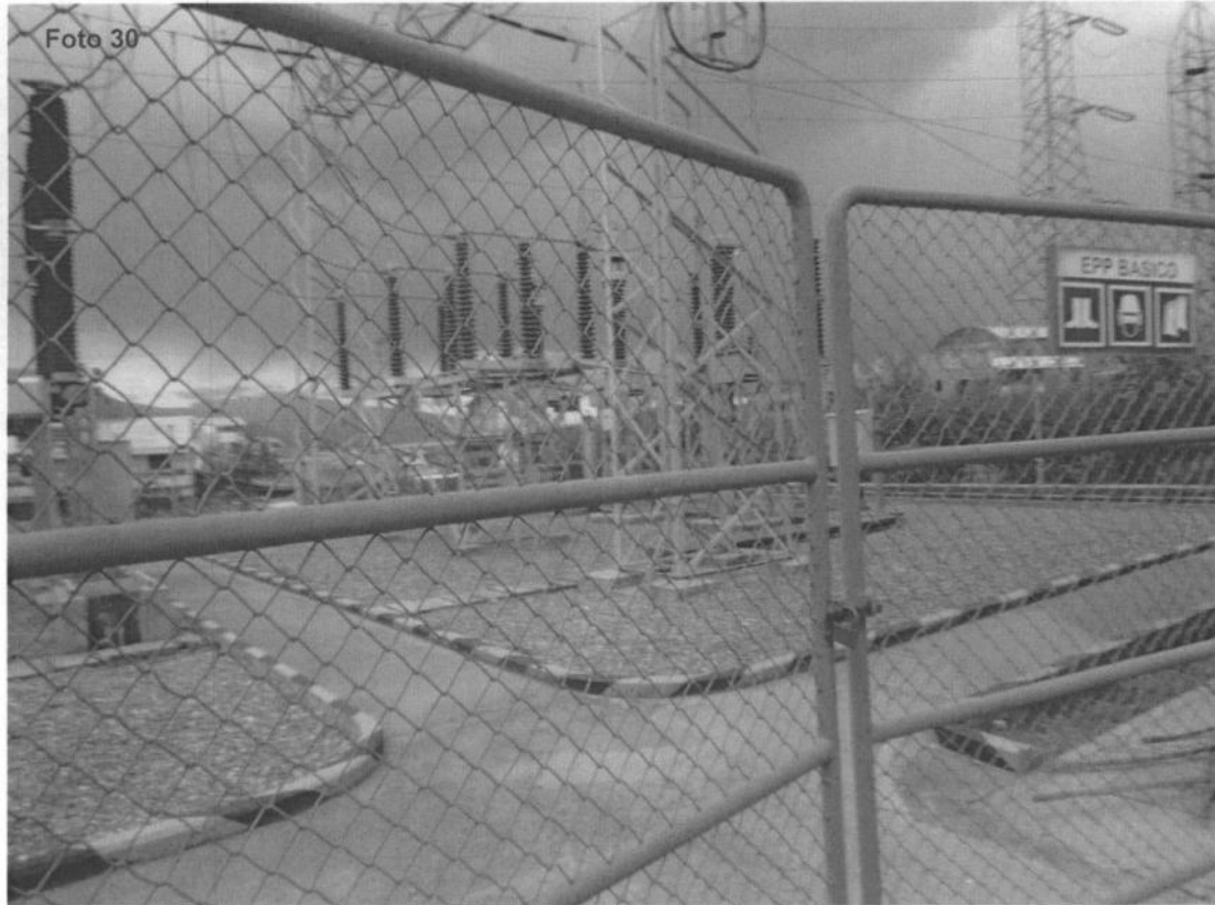
Fotografía N° 30. Vista panorámica del Patio de llaves de los de transformadores de transmisión de potencia, ubicado en la Subestación de Dolorespata de la empresa EGEMSA, en el punto georeferenciado N° 5, del Cuadro N° 2. Coordenadas UTM WGS 84 (19L 178327E 8502282N)
