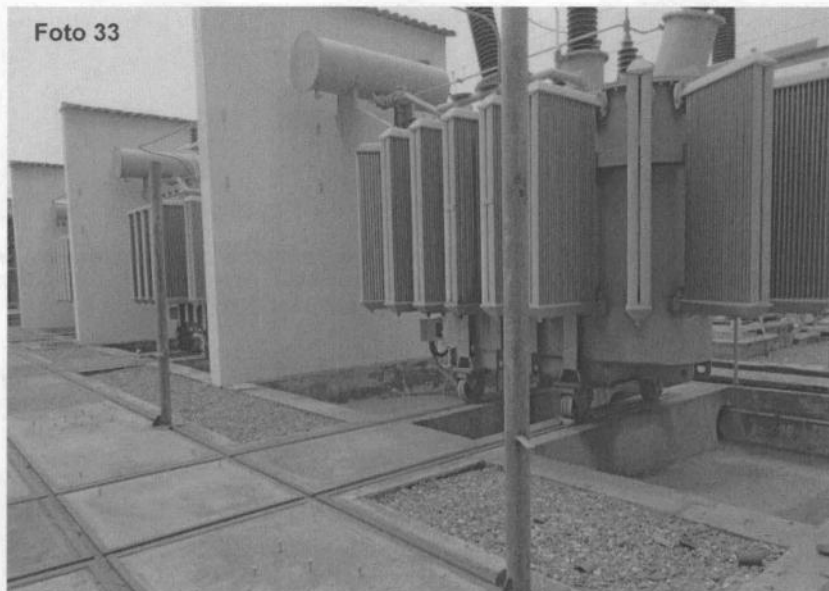
Fotografía N° 33. Vista panorámica de los transformadores de transmisión de potencia operativos Grupo 1, Grupo 2 y Grupo 3, en el patio de llaves de la Subestación de Dolorespata de la empresa EGEMSA, en el punto georeferenciado N° 5, del Cuadro N° 2. Coordenadas UTM WGS 84 (19L 178327E 8502282N)
