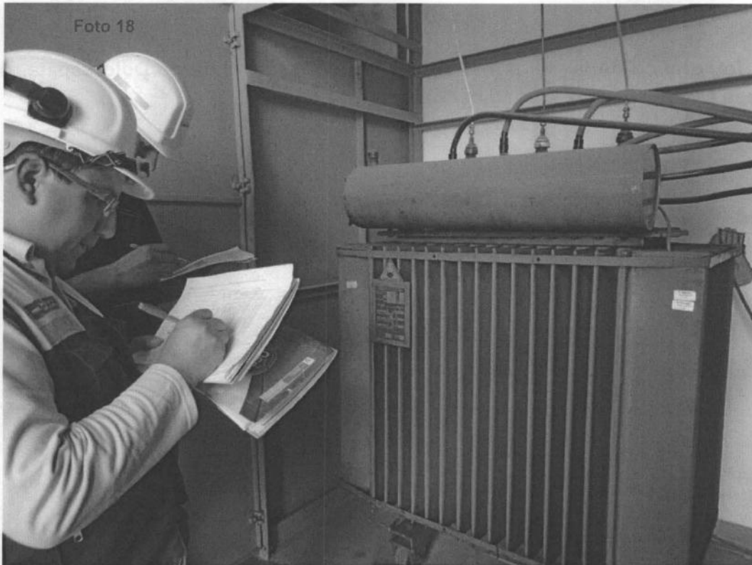
Fotografía N° 18. Evidencia del proceso de evaluación en campo del inventario de transformadores eléctricos en el taller de mantenimiento general de la Central Térmica de Dolorespata de la empresa EGEMSA, en el punto georeferenciado N° 1, del Cuadro N° 2. Coordenadas UTM WGS 84 (19L 178374E 8501976N)
