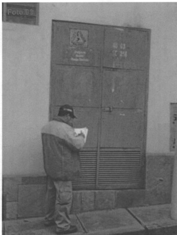
Fotografía N° 93. Evidencia de la evaluación del uso adecuado de aceites dieléctricos en transformadores de distribución en servicio, ubicados en la vía Pública del distrito de San Sebastián; en el punto georeferenciado N° 29, del Cuadro N° 5. Coordenadas UTM WGS 84 (19L 182109E 8502315N)
