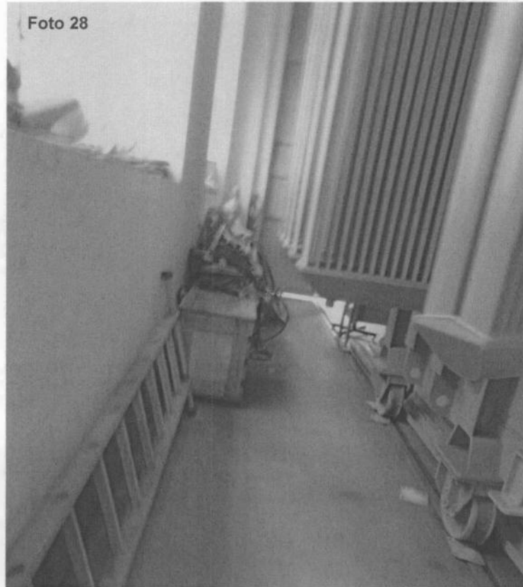
Fotografía N° 28. Evidencia del proceso de evaluación del transformador eléctrico de potencia en reserva, ubicado en el taller de mantenimiento de la Central Térmica de Dolorespata de la empresa EGEMSA, en el punto georeferenciado N° 4, del Cuadro N° 2. Coordenadas UTM WGS 84 (19L 178330E 8502264N)
