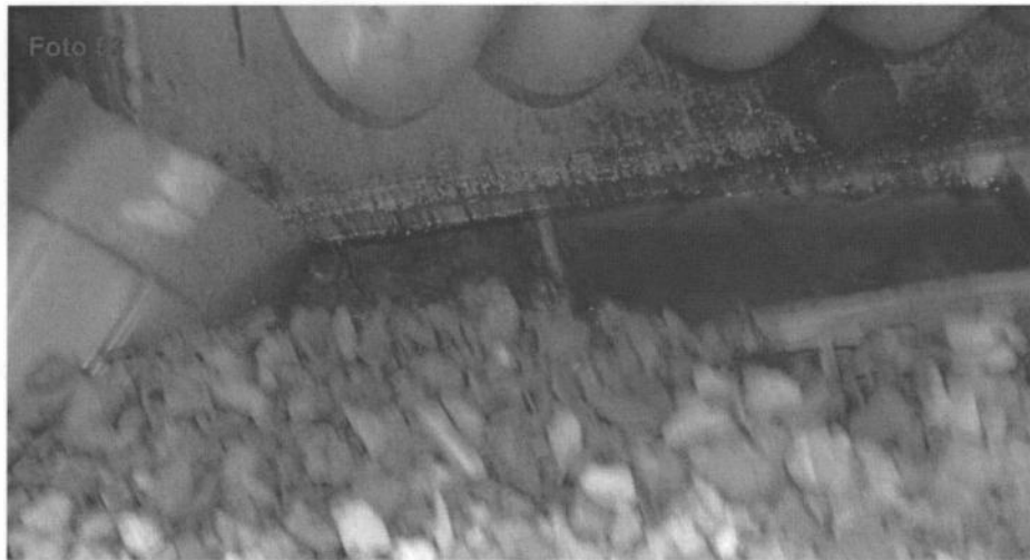
Fotografía N° 53. Evidencia del derrame de aceites dieléctricos y ubicación inadecuada del transformador de Serie N° A7078-2, dicho equipo está pendiente de definir su operatividad o destino final, se ubica en el punto georeferenciado N° 2, del Cuadro N° 3. Coordenadas UTM WGS 84 (18L 817106E 8508556N)
