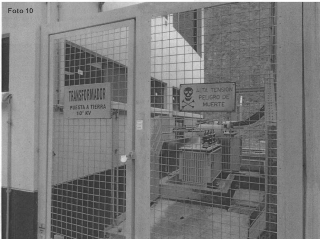
Fotografía N° 10. Evidencia del proceso de evaluación en campo de los transformadores de servicios Serie N° 141778T1 y de Puesta a tierra Serie N° L100338-01, en el patio de llaves de la Central Hidroeléctrica Machupicchu de la empresa EGEMSA, en el punto georeferenciado N° 1, del Cuadro N° 1. Coordenadas UTM WGS 84 (18L 764329E 8542206N)
