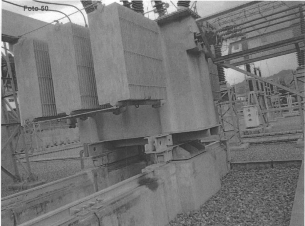
Fotografía N° 50. Evaluación del transformador de potencia de serie N° H68330-01, operativo en la Subestación de Cachimayo, de la empresa EGEMSA, en el punto georeferenciado N° 1, del Cuadro N° 3. Coordenadas UTM WGS 84 (18L 817100E 8508507N)
