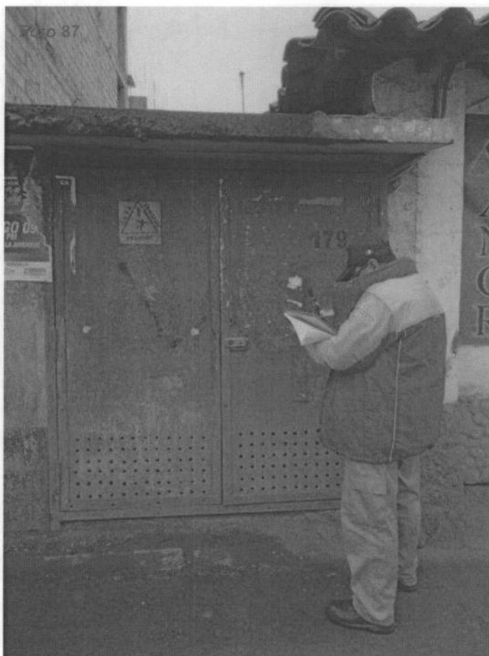
Fotografía N° 87. Evidencia de la evaluación del uso adecuado de aceites dieléctricos en transformadores de distribución en servicio, ubicados en la vía Pública del distrito de Wanchaq; en el punto georeferenciado N° 24, del Cuadro N° 5. Coordenadas UTM WGS 84 (19L 181362E 8501317N)
