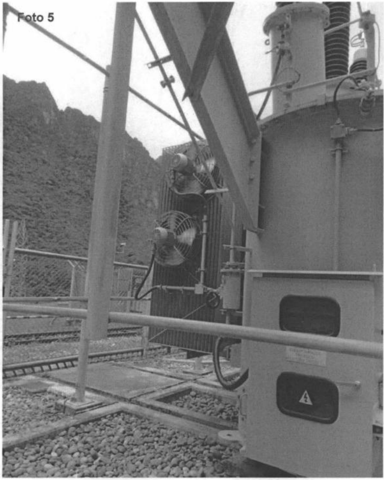
Fotografía N° 5. Evidencia del proceso de evaluación en campo del inventario de transformadores eléctricos de potencia en el patio de llaves de la Central Hidroeléctrica Machupicchu de la empresa EGEMSA, en el punto georeferenciado N° 1, del Cuadro N° 1. Coordenadas UTM WGS 84 (18L 764329E 8542206N)
