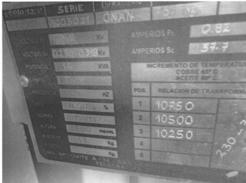
Fotografía N° 13. Evidencia de la placa del transformador aéreo de 15KVA, que no se encuentra inventariado, ubicado en el interior del almacén principal de materiales del campamento de la Central Hidroeléctrica Machupicchu de la empresa EGEMSA, en el punto georeferenciado N° 3, del Cuadro N° 1. Coordenadas UTM WGS 84 (18L 764717E 8542231N)
