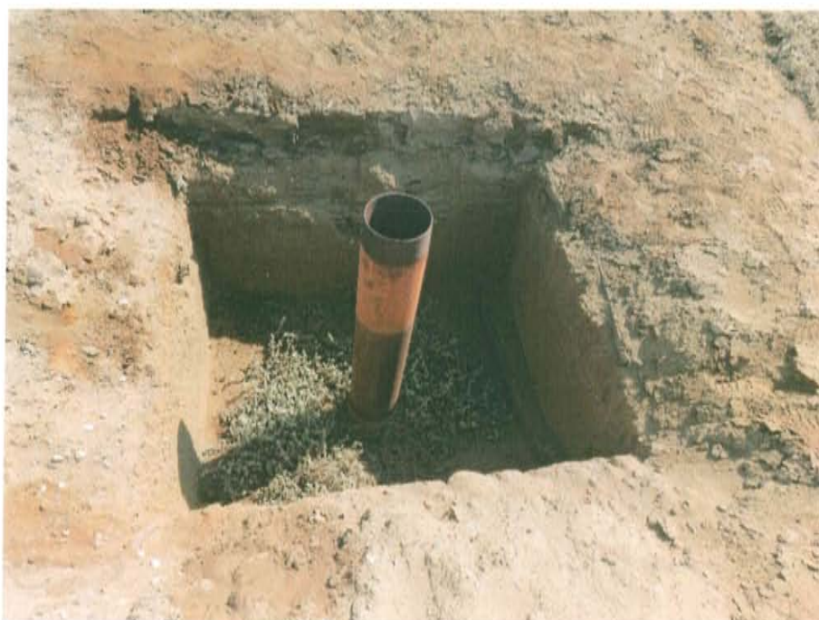
Fotografía N° 2. Se observa pozo inactivo que presenta una casing el cual se encuentra abierto, sin elemento de cierre tales como válvulas, llaves entre otros, que garantizan un cierre hermético del pozo.
