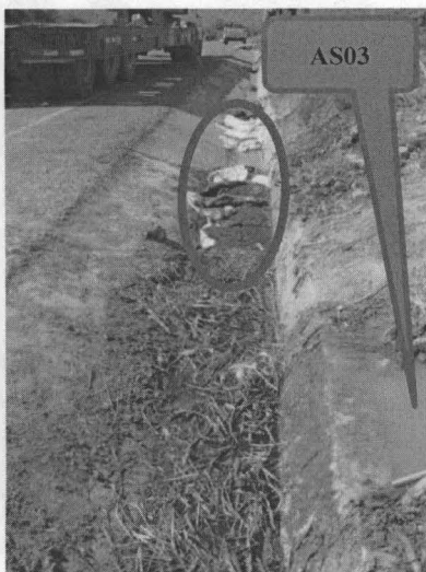
Fotografía 3-a. Presencia de petróleo en agua de la cuneta colectora de agua superficial remanente y pluvial, punto de muestreo AS03.
