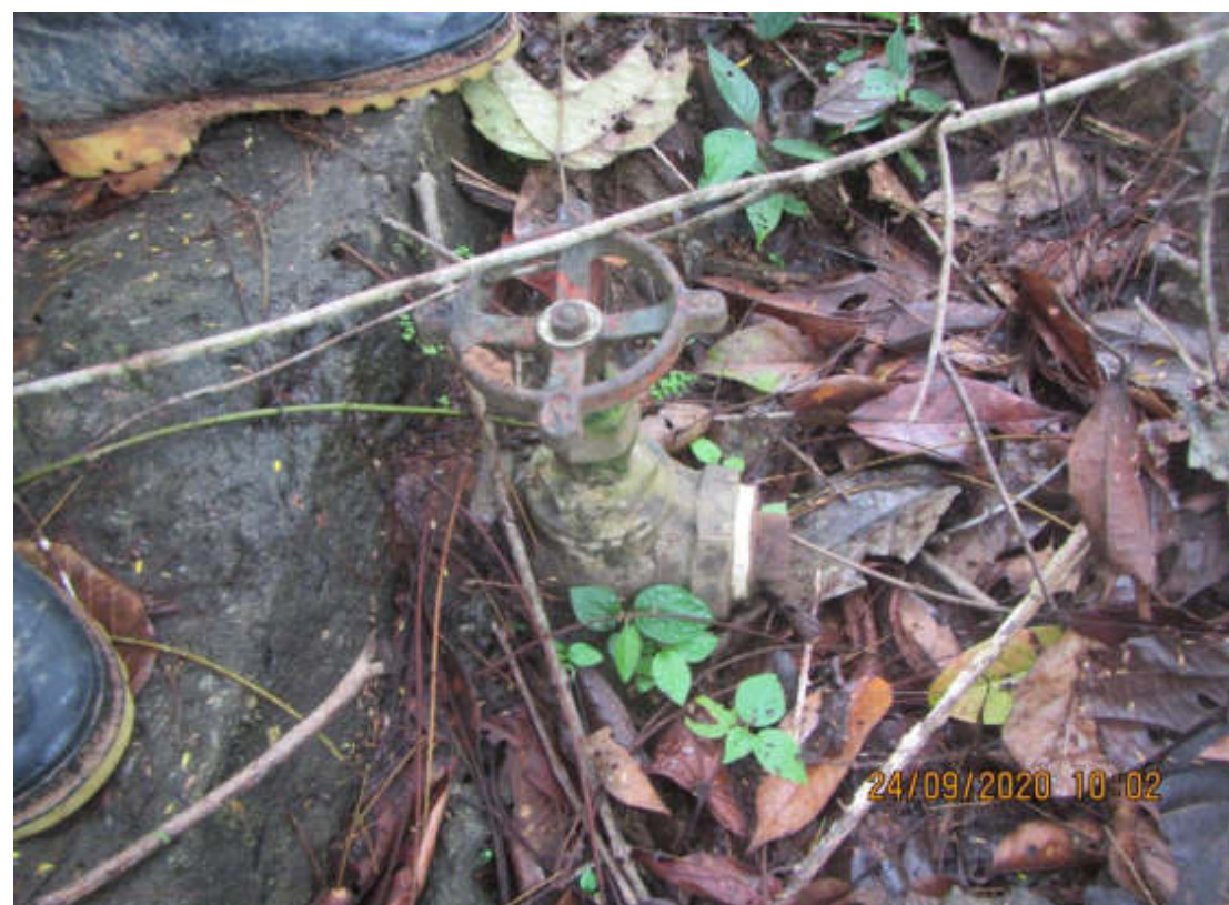
Imagen del desfogue de la tubería que viene del tanque sumidero (Sump Tank), ubicado al lado oeste del sitio
