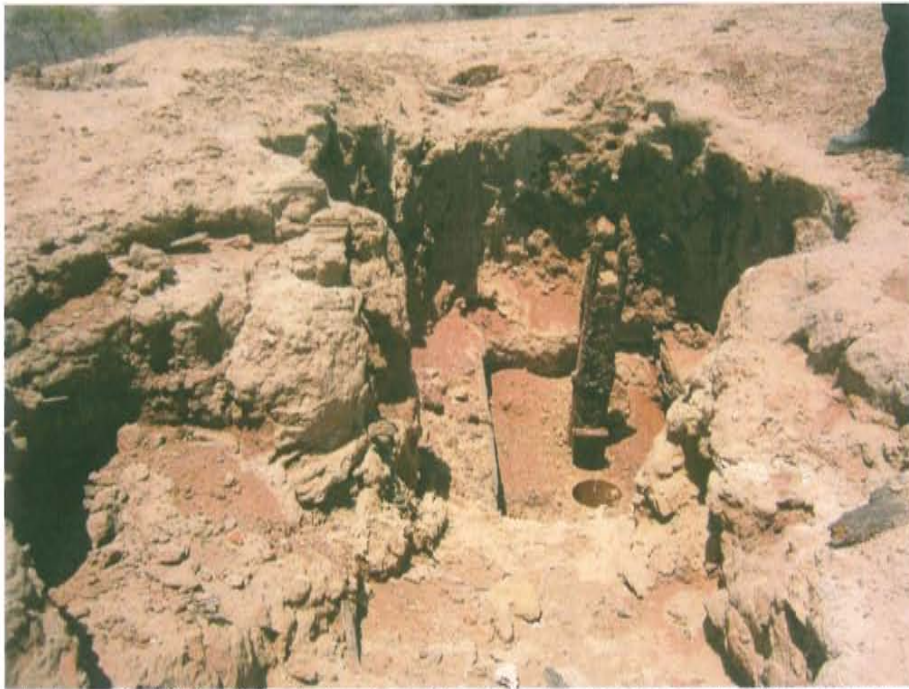
Fotografía N° 1. Vista de la ubicación del pozo donde se observa el casing (Tubo de revestimiento) sin brida ni accesorios que aseguren su hermetismo.
