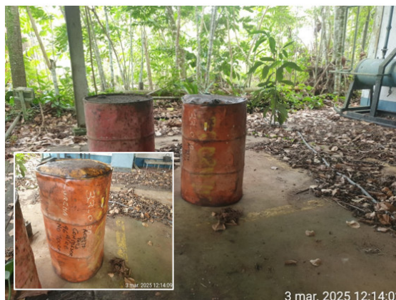
Se observa cilindros conteniendo aceite para vehículos y maquinarias (compresora de aire) en un área de la estación eléctrica.
