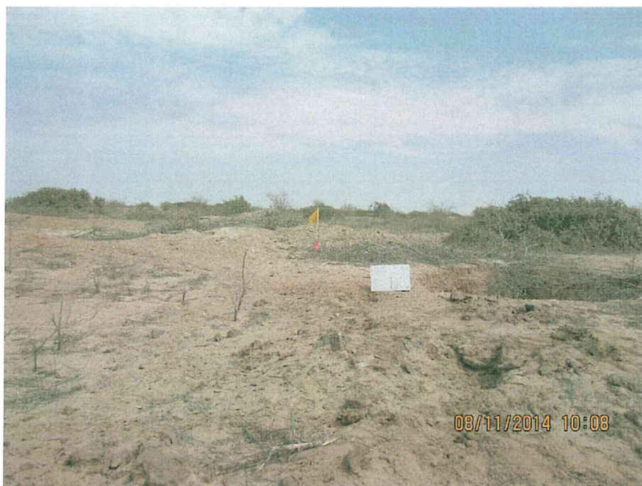
Fotografía N° 1. Se observa una excavación cercana a las coordenadas UTM proporcionadas por el OSINERGMIN.
